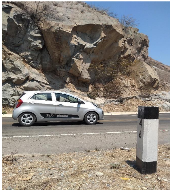
Figura 15: Desprendimiento. Elaboración propia.
