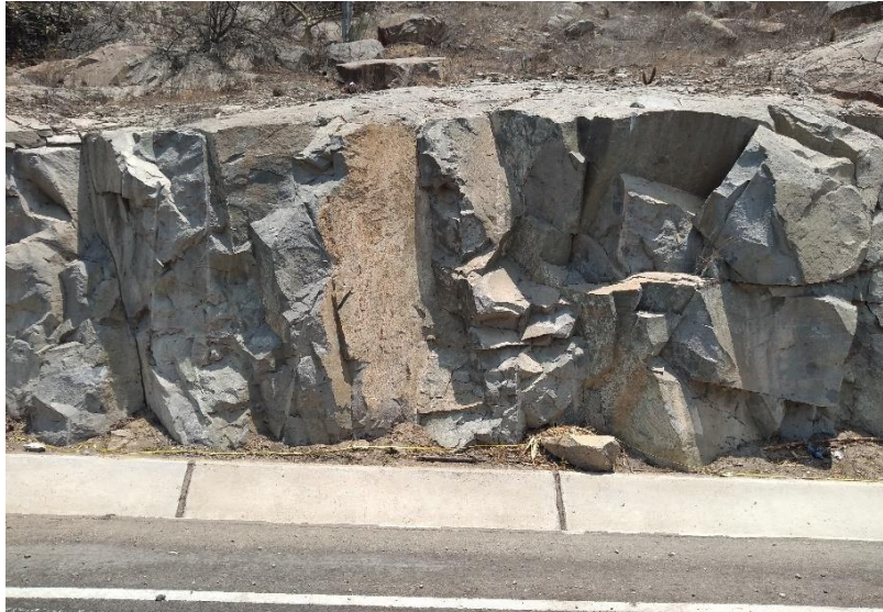
Figura 20: Rotura en cuñas.
