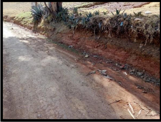
Problemas de estabilidad en el sector vial Paria – Recrish.
