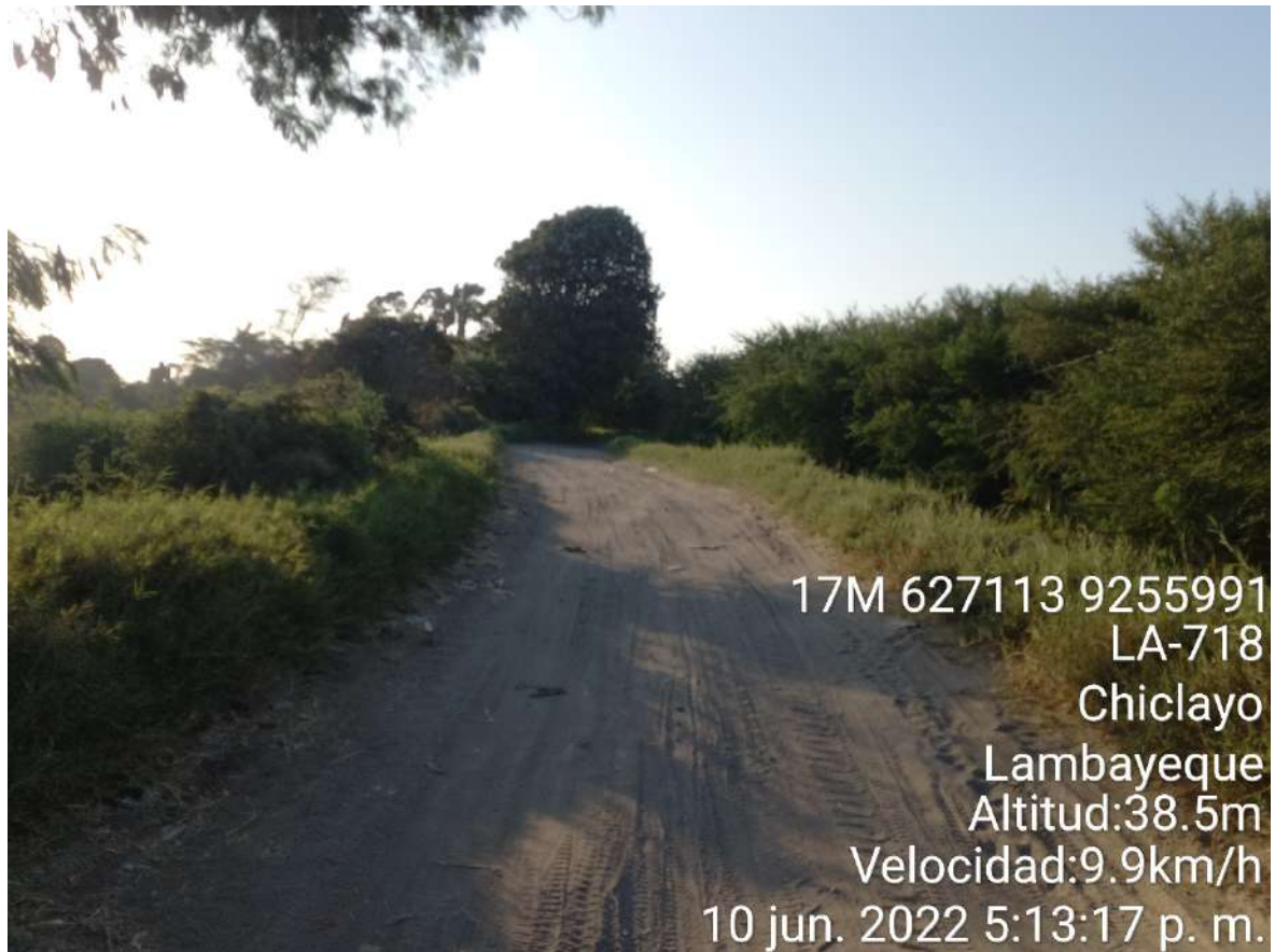
Figura 19. Estado actual de la vía trocha carrozable
