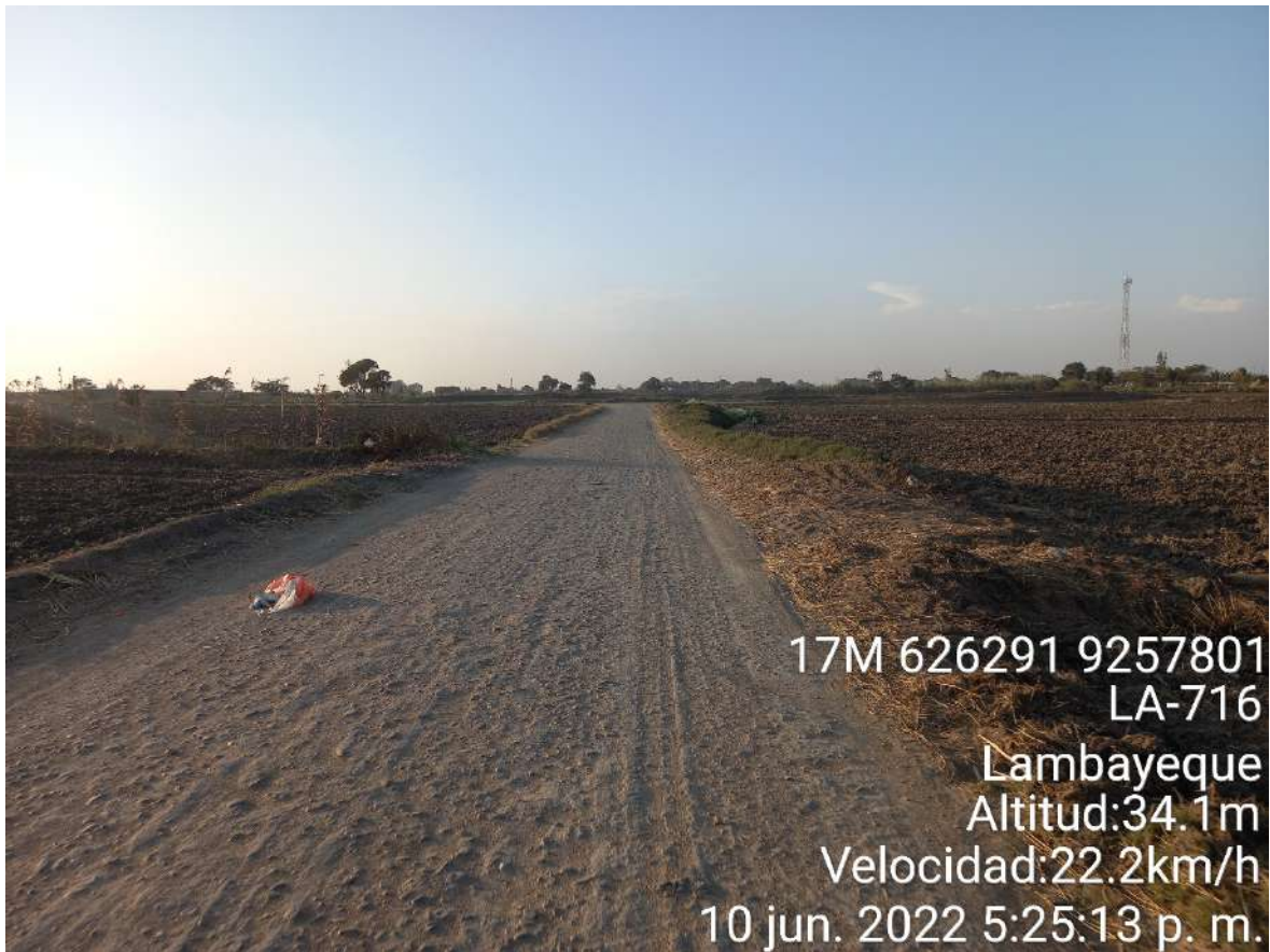
Figura 20. Estado actual de la vía trocha carrozable
