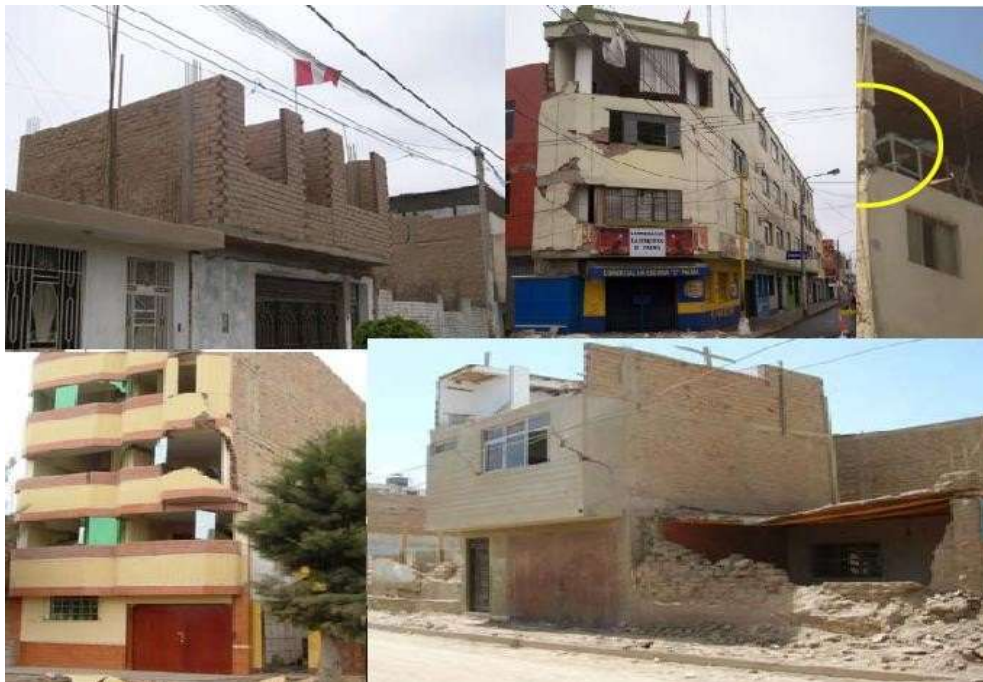
FIGURA 9. Deficiencias en las Construcciones de Albañilería Confinada
