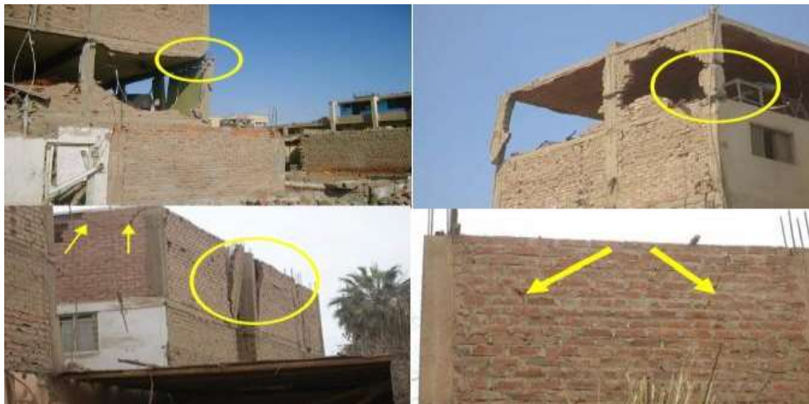
FIGURA 7. Daños de edificaciones de Albañilería Confinada
