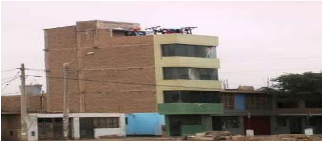
FIGURA 8. Deficiencias en las Construcciones de Albañilería Confinada.
