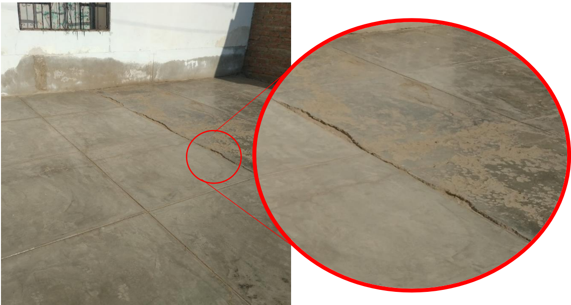
Figura. Asentamiento en un patio en el Centro Poblado Capote
