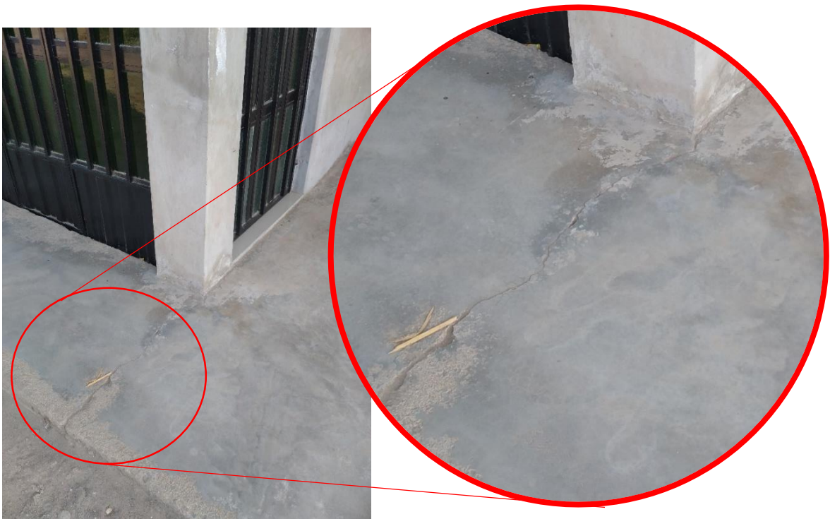
Figura. Asentamiento de vereda y agrietamiento
