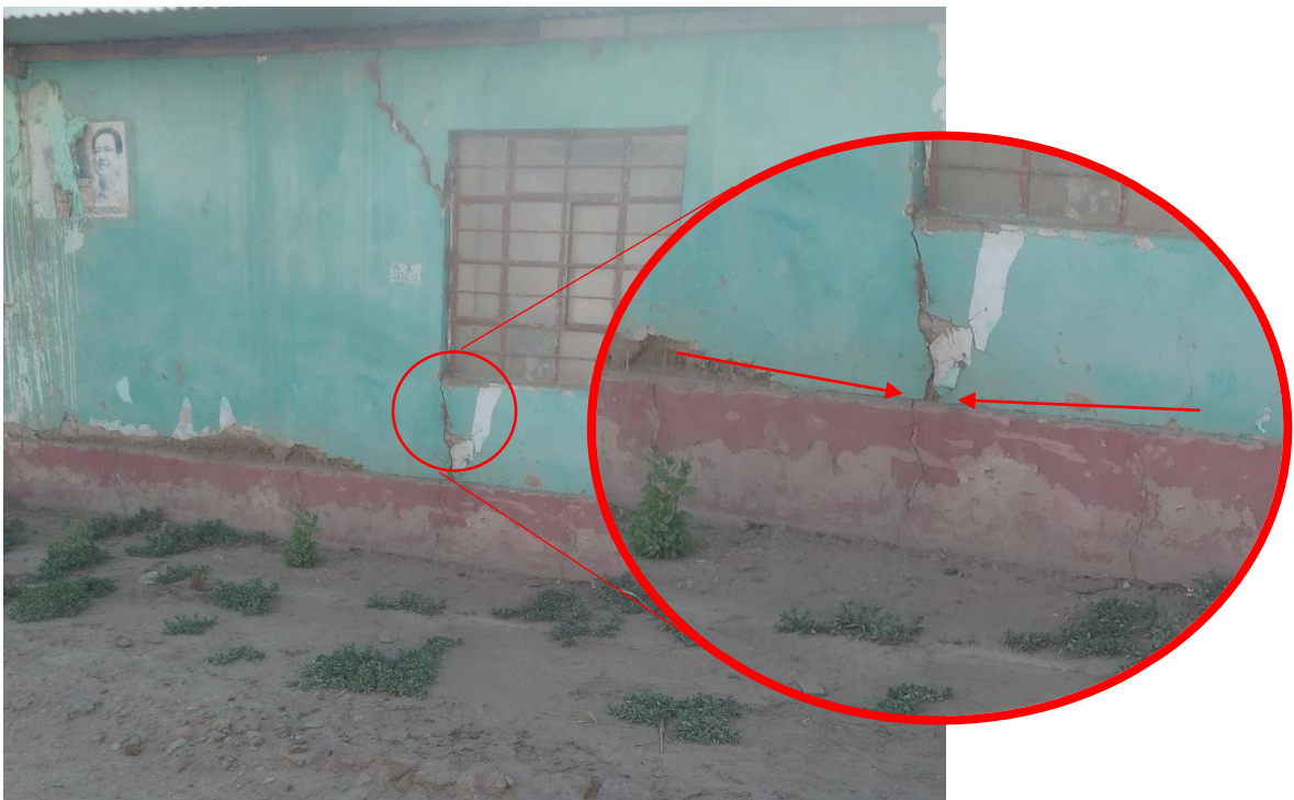
Figura. Asentamiento de muro generando agrietamiento
