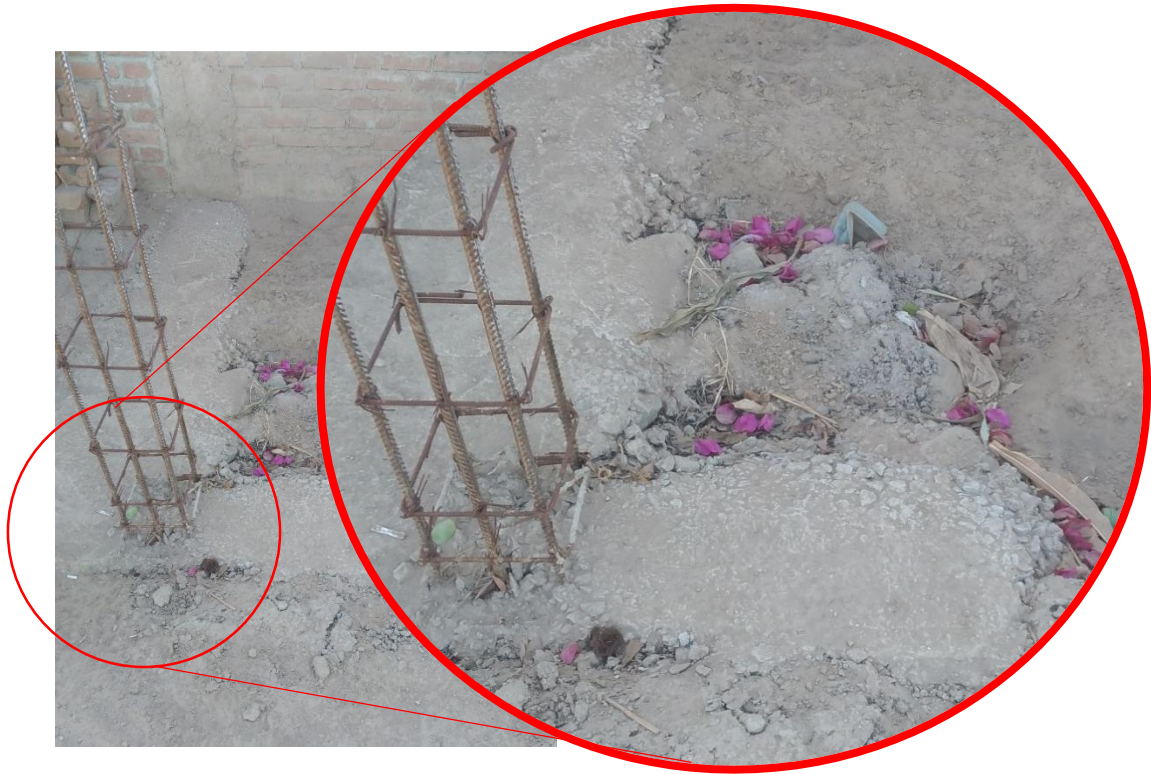
Figura. Columna hecha sin ningún criterio técnico sin una cimentación
