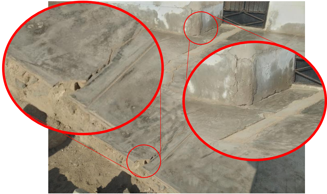
Figura. Asentamiento de vereda y muros causando agrietamiento
