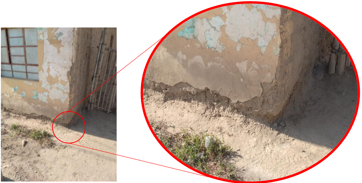
Figura. Erosión de muros por falta de un estudio de mecánica de suelos
