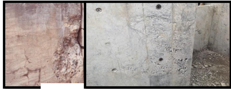
GRIETAS EN PISO
