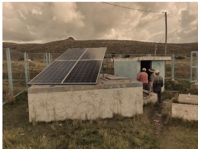
Figura 21. Pruebas del sistema fotovoltaico
