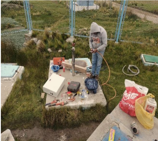
Fotografía 07: Estacionamiento y de los equipos de del sistema fotovoltaico
