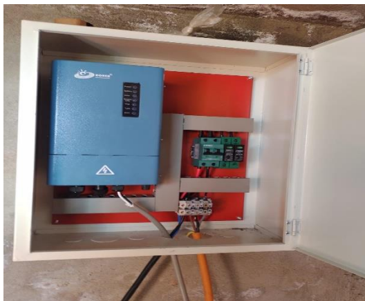
Fotografía 09: Prueba y dimensionamiento de regulador/controlador de carga.
