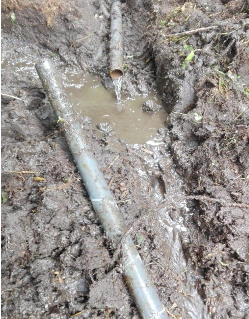
Sistema de saneamiento básico rural en la localidad de Pueblo Viejo, Yauyucan-Cajamarca – tuberías de sistema de agua potable en mal estado, 2022.
