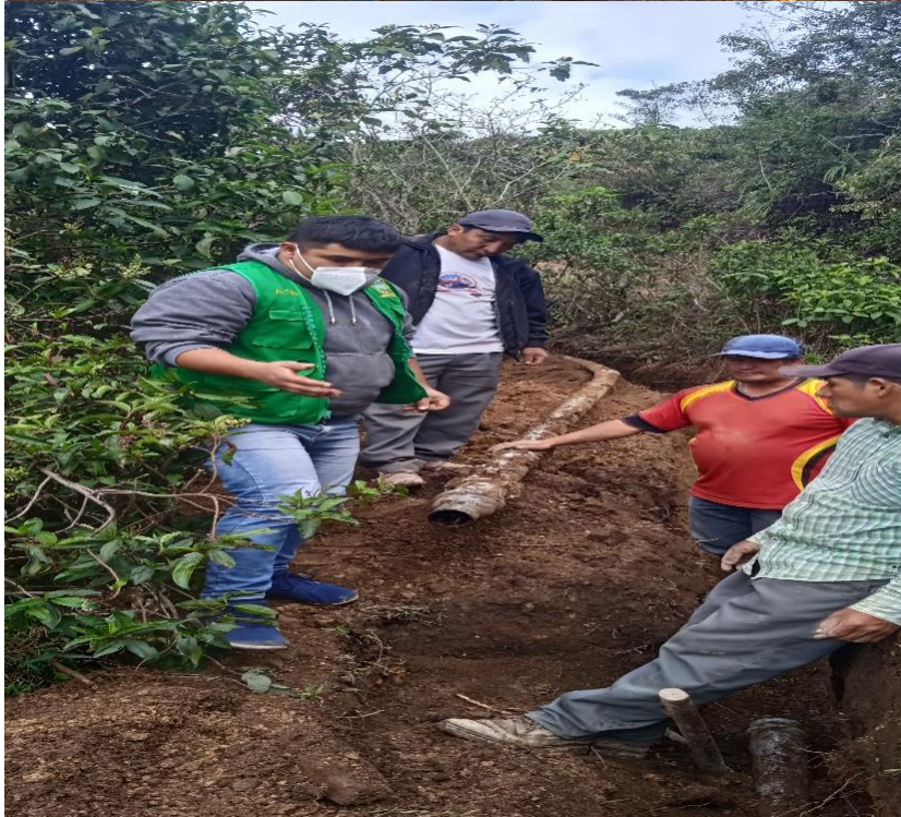
Sistema de saneamiento básico rural en la localidad de Pueblo Viejo, Yauyucan-Cajamarca – tuberías de sistema de agua potable en mal estado, 2022.
