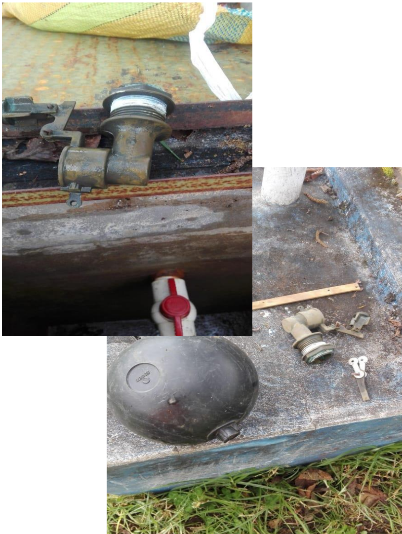
Sistema de saneamiento básico rural en la localidad de Pueblo Viejo, Yauyucan-Cajamarca – Válvula dañada, 2022.
