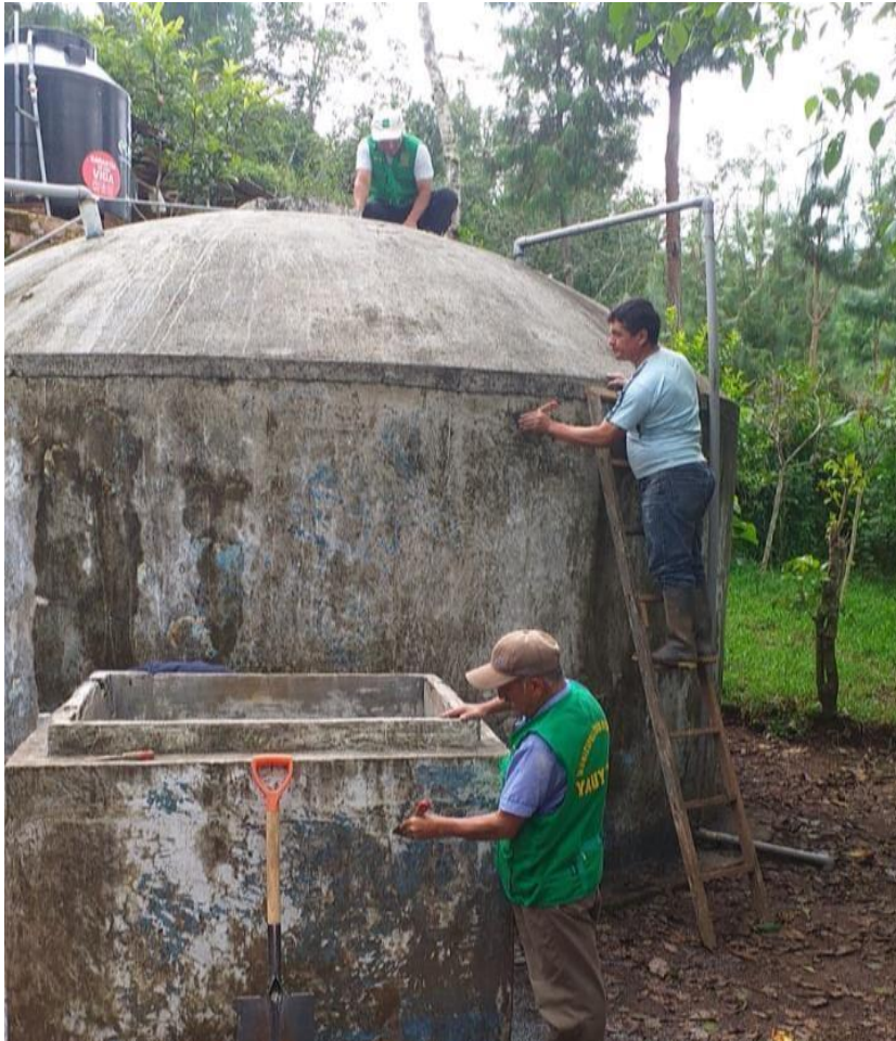
Sistema de saneamiento básico rural en la localidad de Pueblo Viejo, Yauyucan-Cajamarca – reservorio en mal estado. 2022.
