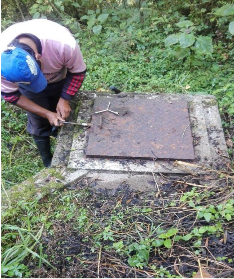
Sistema de saneamiento básico rural en la localidad de Pueblo Viejo, Yauyucan-Cajamarca -Estanque en mal estado,2022.
