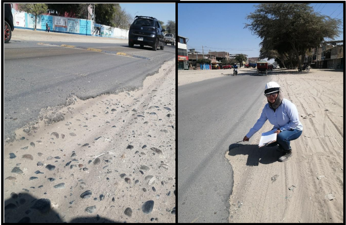
Figura 13. Presencia de falla desintegración de los bordes del pavimento (DB)
