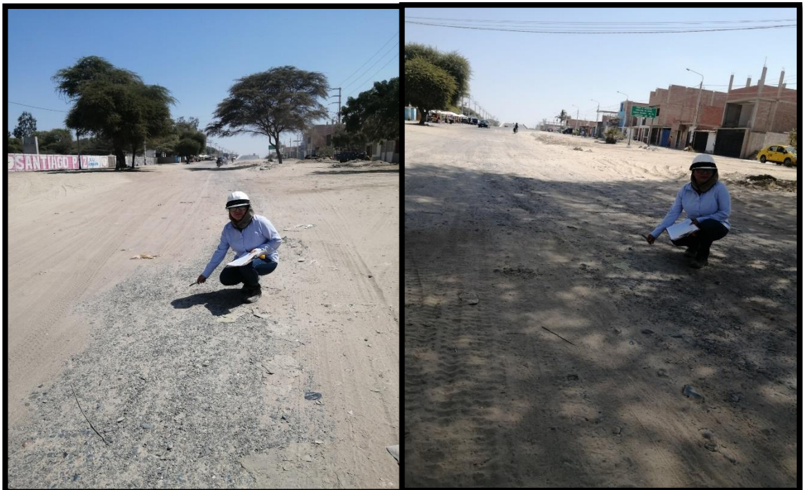
Figura 22. Presencia de falla pérdida de agregados (PA) y ahuellamientos (AH)
