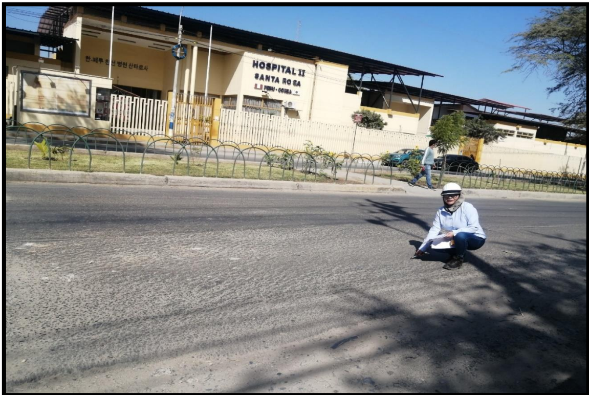
Figura 6. Presencia de falla perdida de película ligante (PL)
