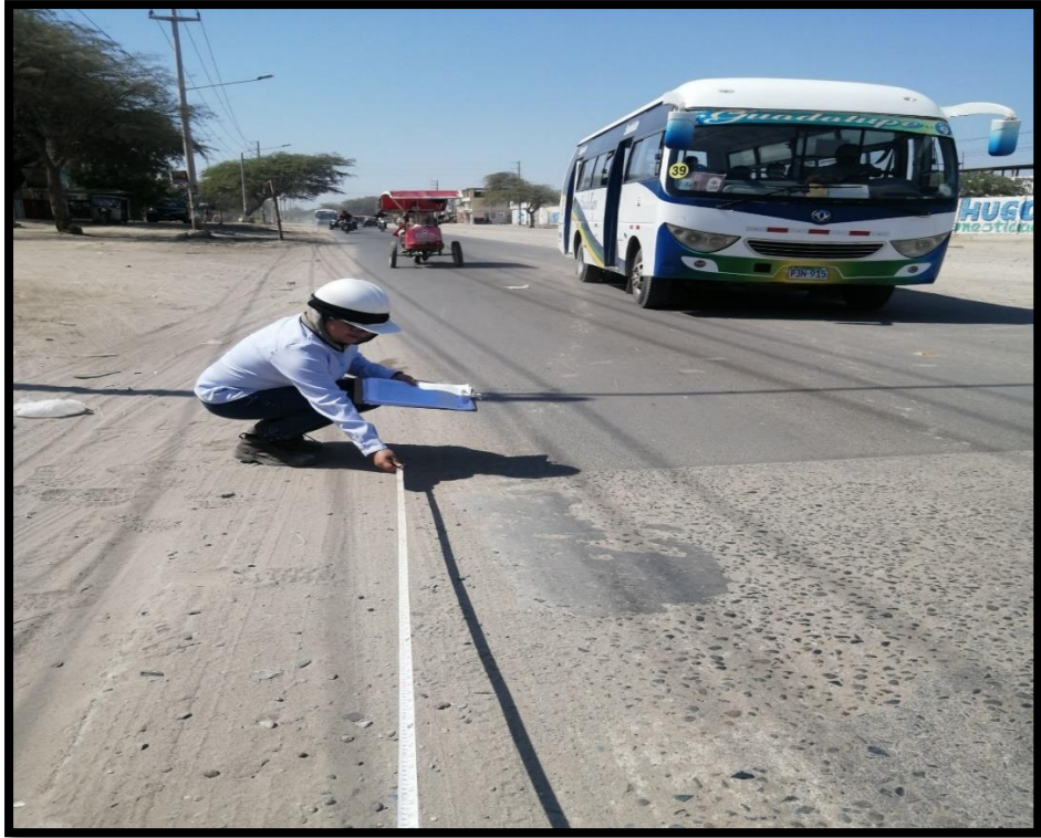
Figura 11. Medición de fallas en la Av. Graú
