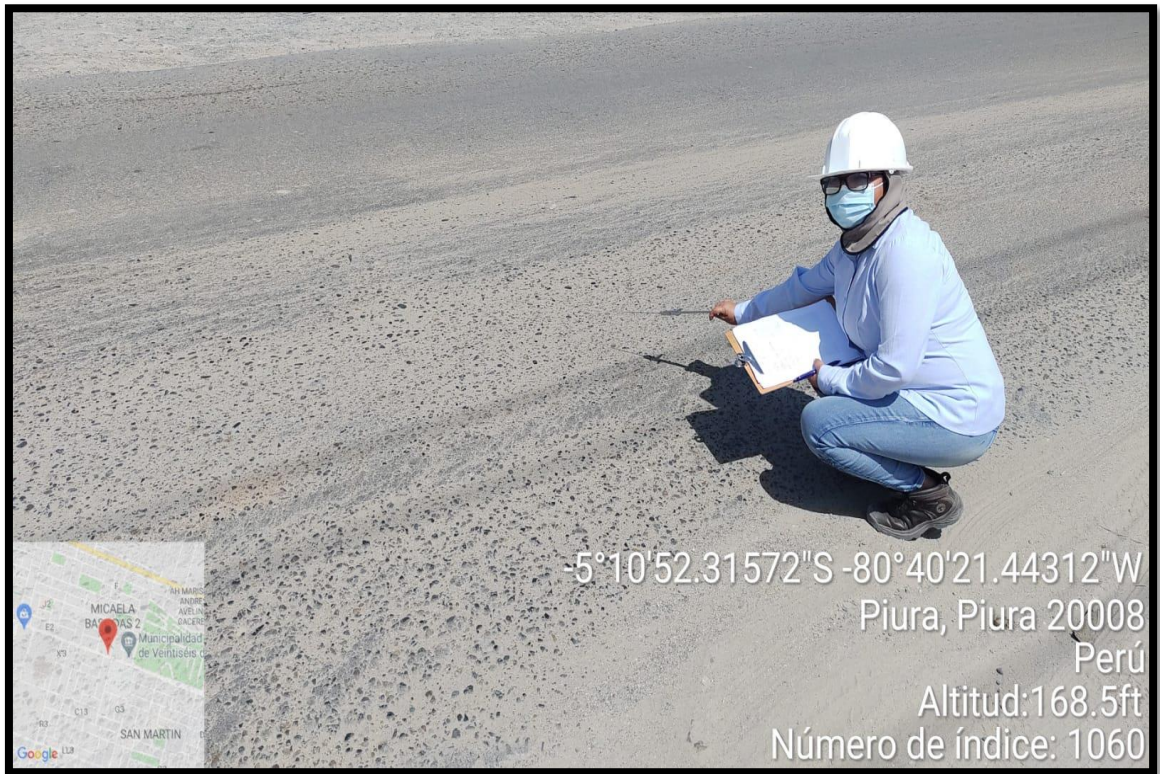
Figura 15. Presencia de falla perdida de película ligante (PL)
