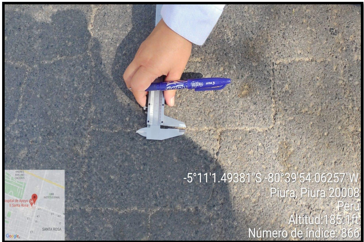
Figura 7. Presencia de falla piel de cocodrilo (FPC)
