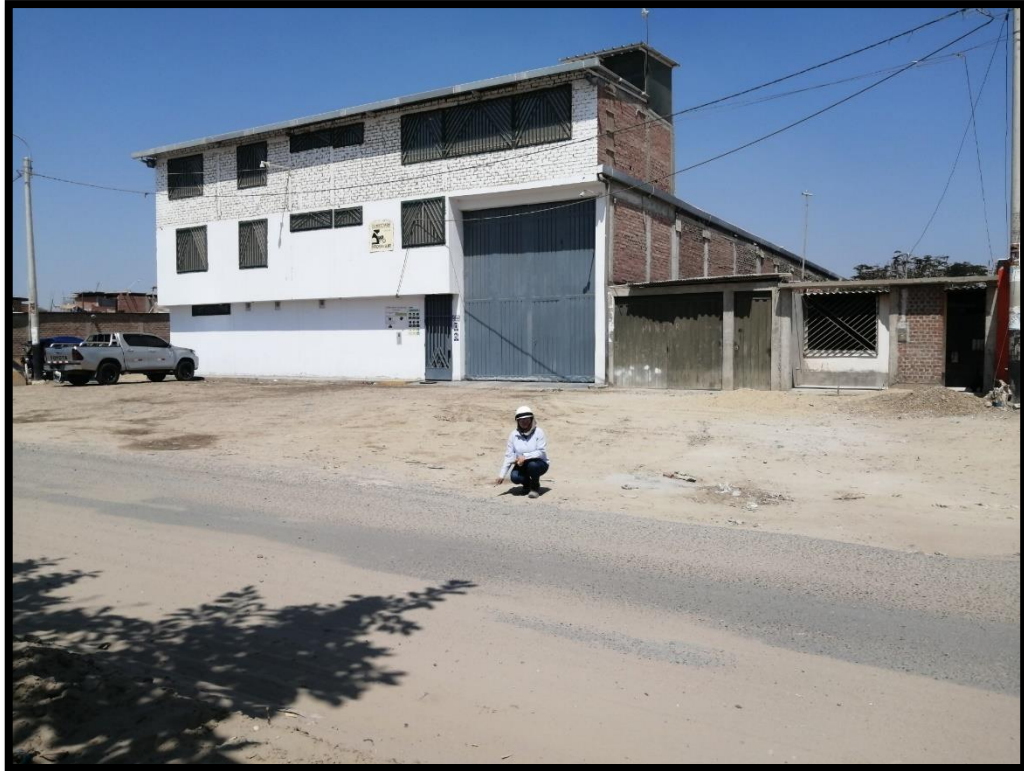
Figura 21. Presencia de pérdida de agregado (PA) y desintegración de bordes del pavimento (DB)
