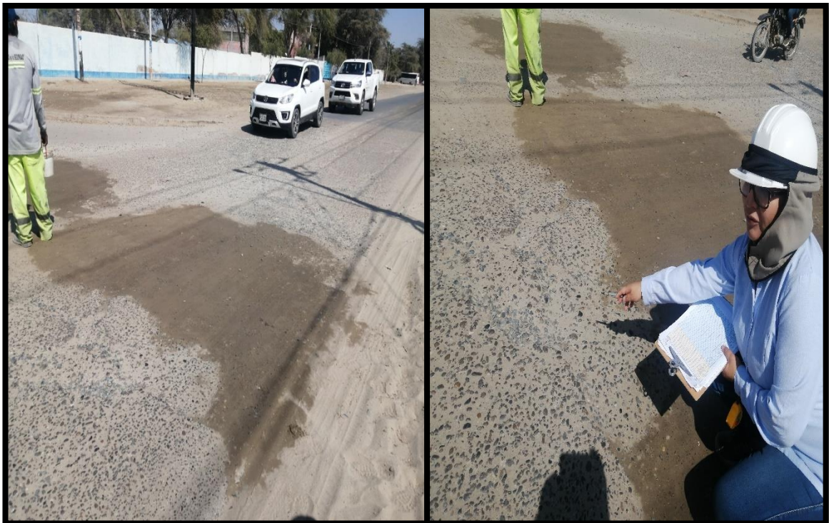
Figura 12. Presencia de falla pulimiento de agregados (PU)
