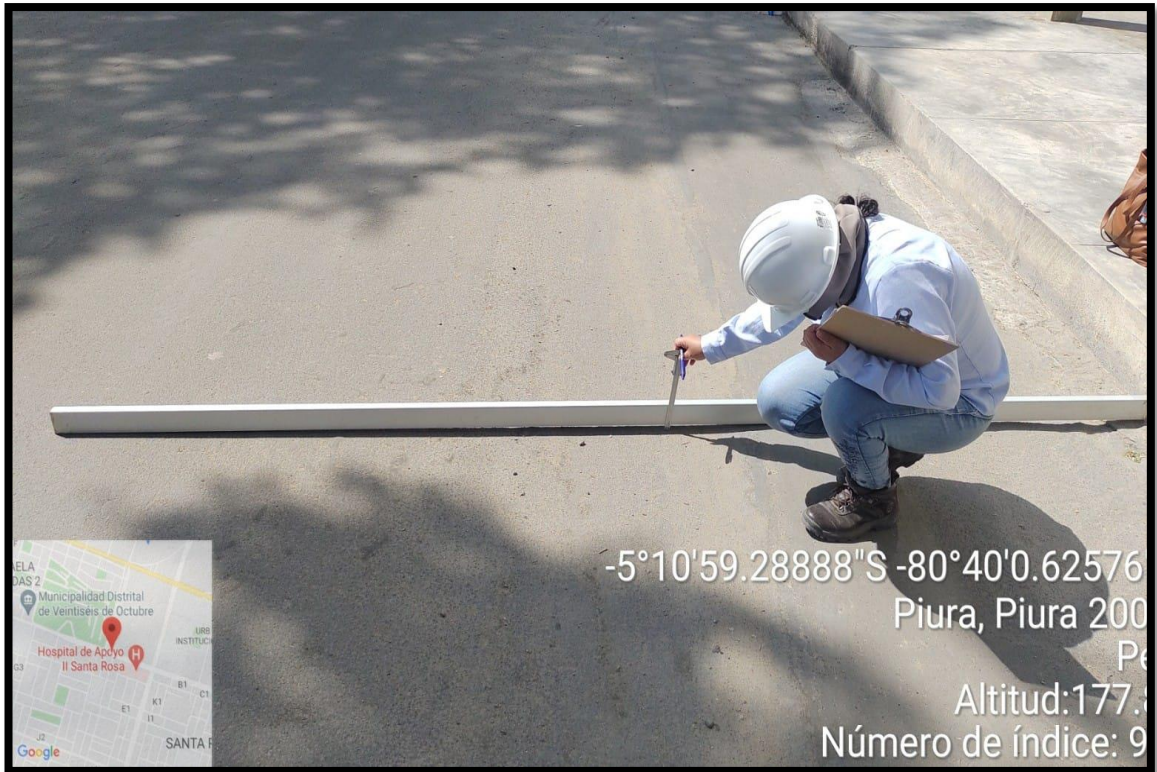
Figura 9. Presencia de falla ahuellamiento (AH)
