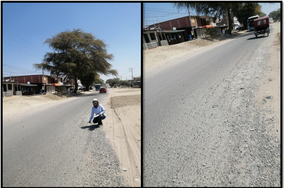
Figura 19. Presencia de falla perdida de agregados (PA)
