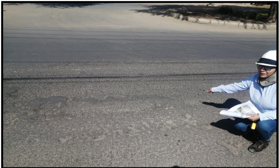
Figura 16. Presencia de falla descascamiento (D)
