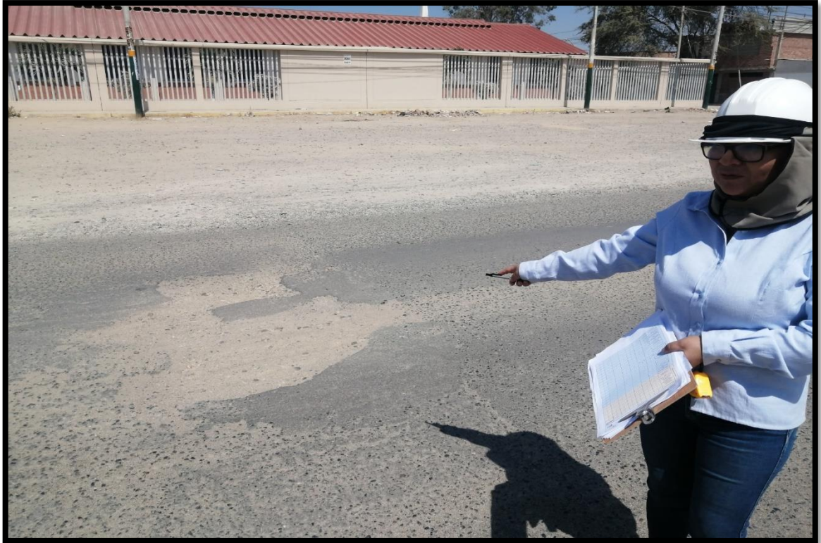
Figura 20. Presencia de falla perdida de agregados (PA)
