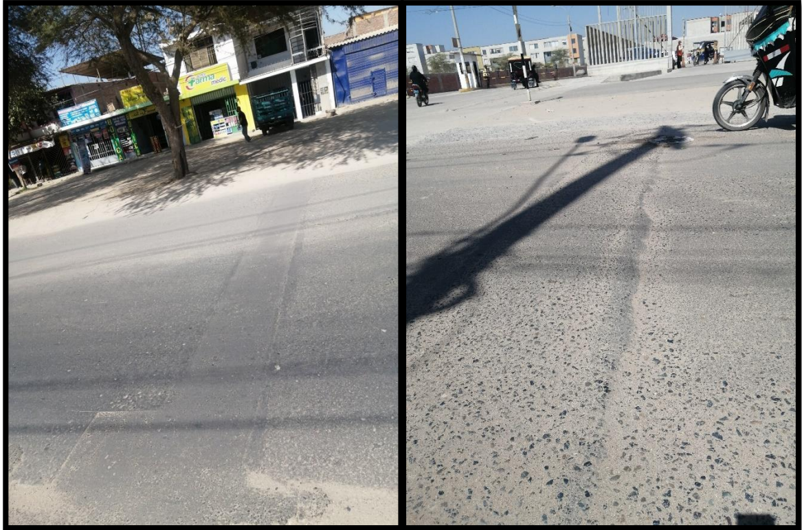
Figura 17. Presencia falla tipo parcheo (B)
