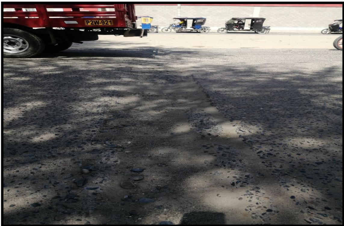
Figura 18. Presencia de falla por fisura transversal junta de construcción (FTJ)
