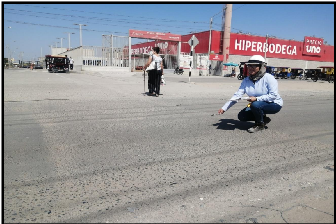
Figura 14. Presencia de falla perdida de película ligante (PL)
