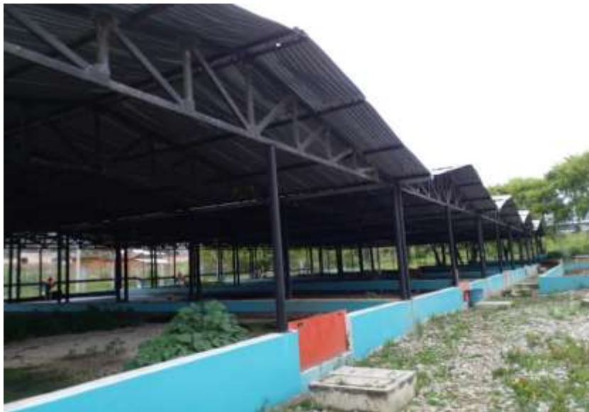
Figura 4: Lecho de secado de los lodos residuales de la PTAR de la provincia de Celendín
