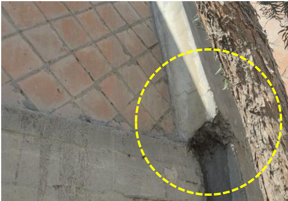
Figura 14. Discontinuidad del elemento estructural de la Parroquia
