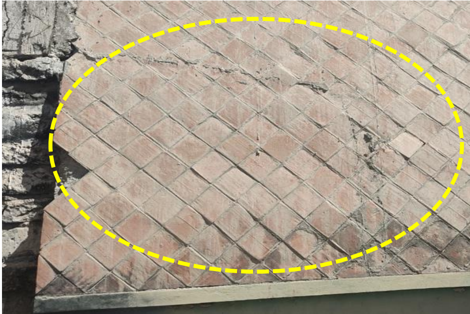
Figura 23. Grietas en los muros de la estructura
