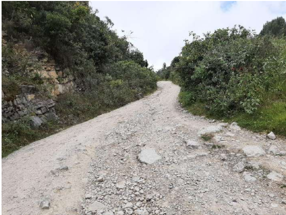
Figura 3: Mal estado del tramo en estudio.
