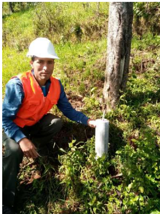
Figura 2: Colocación del BM, los Bm's usados fueron Bm's monumentados a base de concreto.
