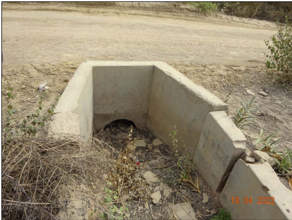
Foto N° 11: Alcantarilla existente en malas condiciones, presentando problemas de colmatación, Agrietamiento, y vegetación.
