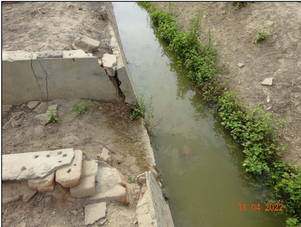
Foto N° 12: Alcantarilla existente en malas condiciones, presentando problemas de colmatación, Agrietamiento, y vegetación.
