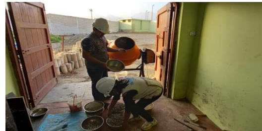
Anexo 20.6. preparación de diseño de mezcla de un concreto 350 kg/cm 2 en trompo.
