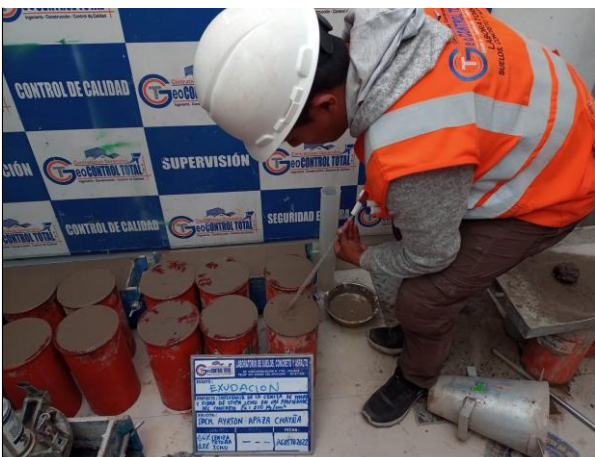
EVIDENCIA FOTOGRAFICA N° 35. DESCRIPCION: Ensayo de exudacion en el concreto en estado fresco. 2022
