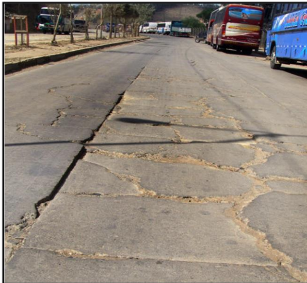
Figura 1. Fisura en bloques del pavimento rígido.
