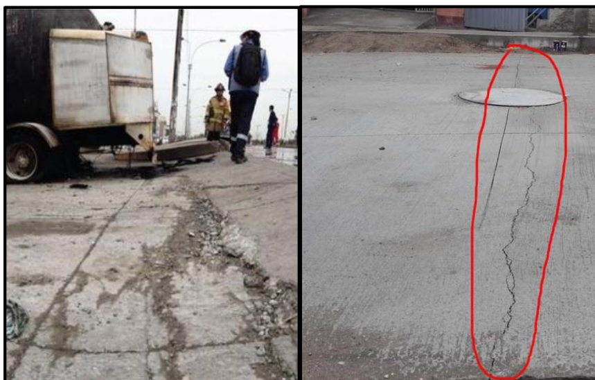
Figura 2. Falla del pavimento rígido; desprendimiento del concreto y fisura transversal en toda la vía en el distrito de Villa el Salvador.
