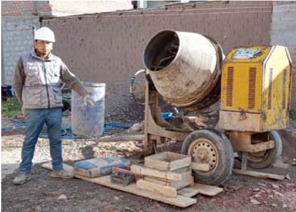
Fotografía 25. “Equipos, herramientas y materiales usados para la elaboración de ladrillos de concreto”
