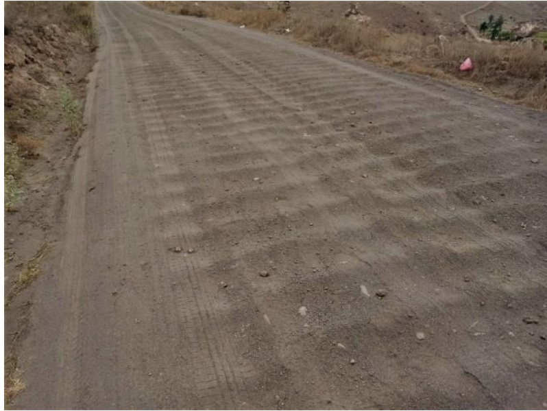
Figura 16. Encalaminado excesivo. Progresiva 5+000
