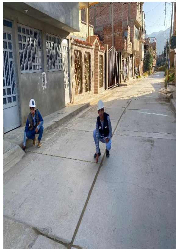
Grieta longitudinal progresiva km 00+036
