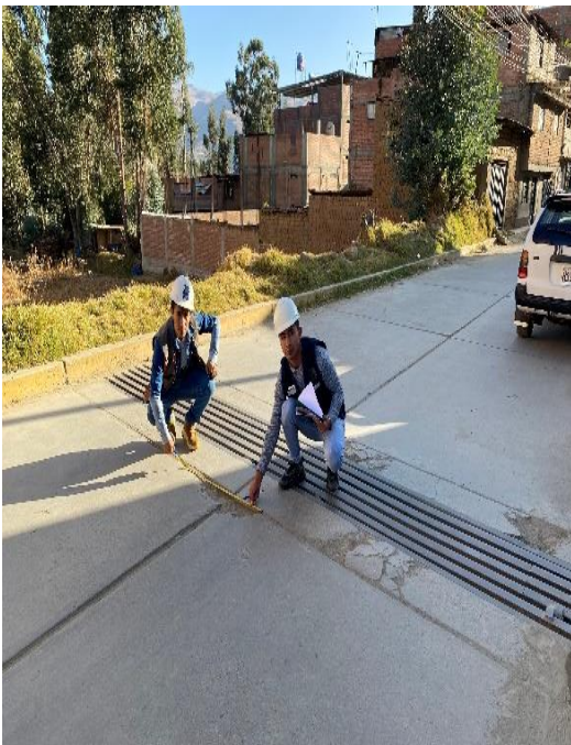
Grieta en esquinas Progresiva km 00+ 084
