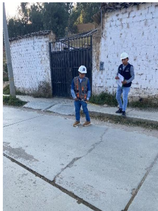
grieta transversal progresiva km 00+112
