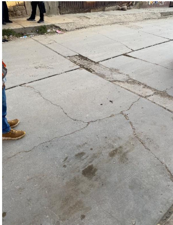
loza dividida progresiva km 00+132
