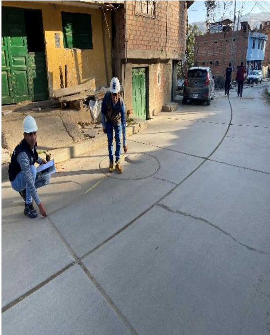
Grieta longitudinal Progresiva km 00+ 092
