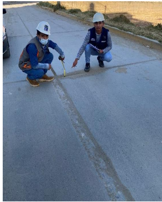
asentamiento progresiva km 00+052
