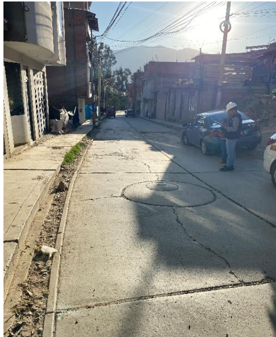
grietas en 3 paños del pavimento progresiva km00+294
