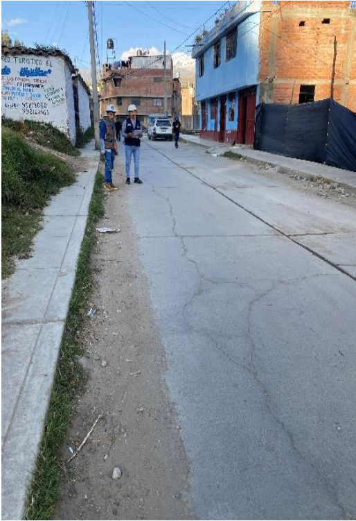
Grieta longitudinal en 3 paños Progresiva km 00+ 120
