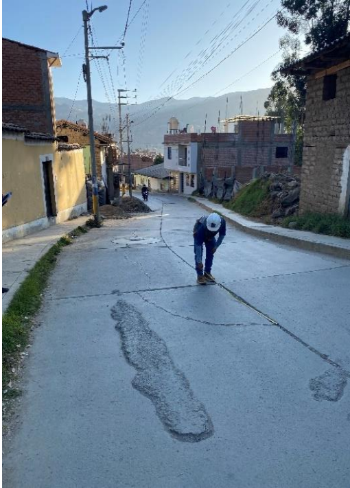
Grieta en esquina
