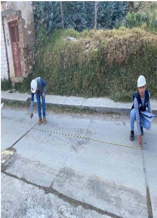
Grieta longitudinal Progresiva km 00+104
