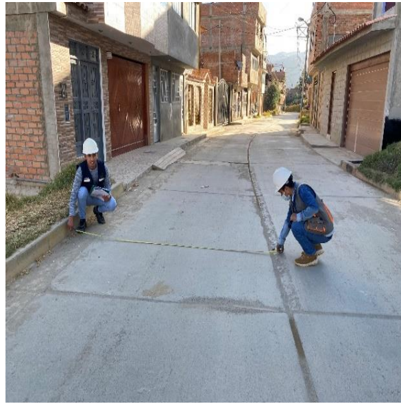
Grieta transversal progresiva km 00+ 015
