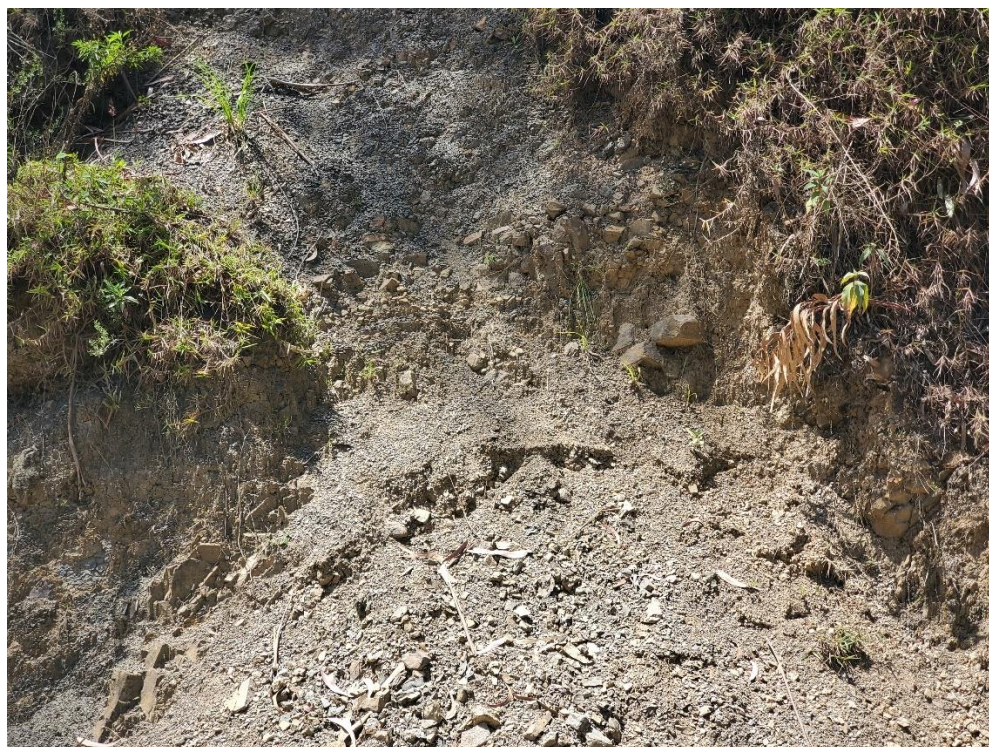
Figura 3. Trocha carrozable Tuctilla – Taquia, zona de deslizamiento de terreno Fuente: Elaboración propia
