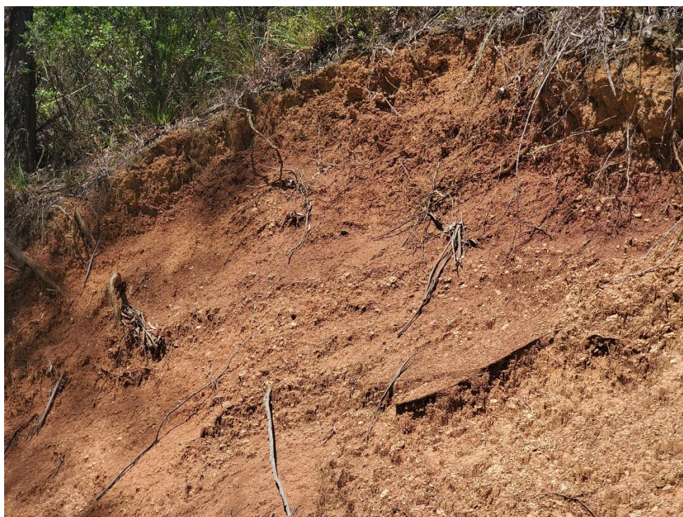
Figura 2. Trocha carrozable Tuctilla – Taquia, zona de deslizamiento de terreno Fuente: Elaboración propia
