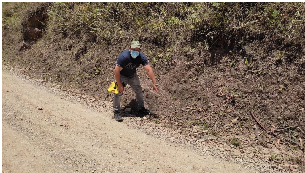
Figura 1. Trocha carrozable Tuctilla – Taquia, zona de deslizamiento de terreno Fuente: Elaboración propia
