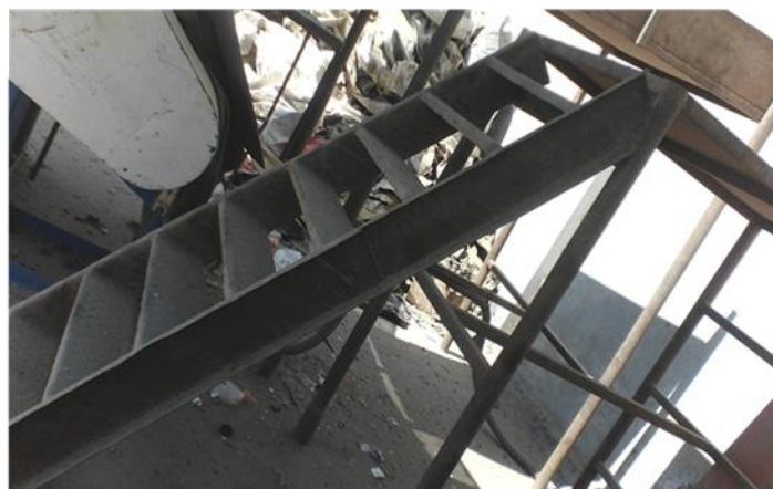
Figura N° 15. Escalera por donde el operario sube el material plástico hacia la moledora con una altura de 1,5 metros, con riesgo de accidente
