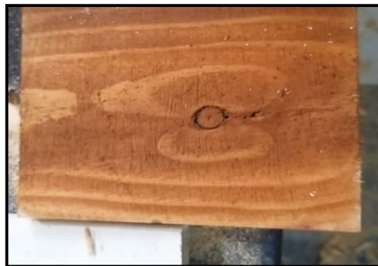
Figura 11. Inadecuada conservación de materiales.
