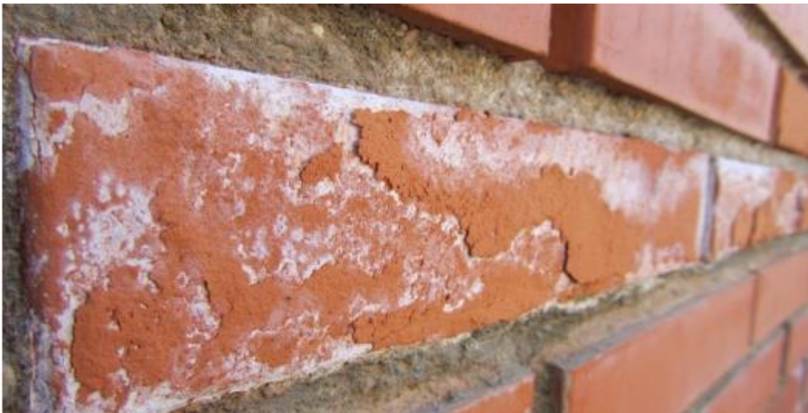
Figura 9: Eflorescencias de ladrillos
