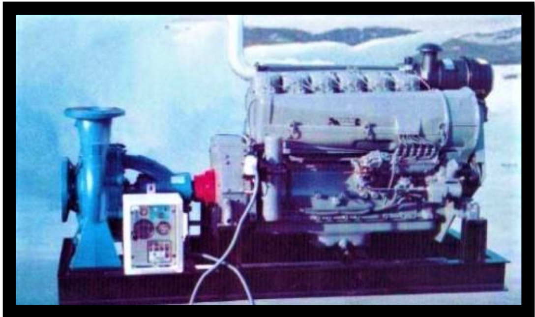
Fig. 06: Motobomba a utilizar en la Comuna de los Cedros. Fuente: El SAA"P, Rondon, A. (2019).
