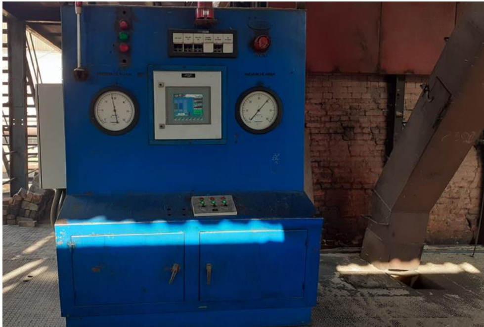
Monitor de control Caldera No 01
