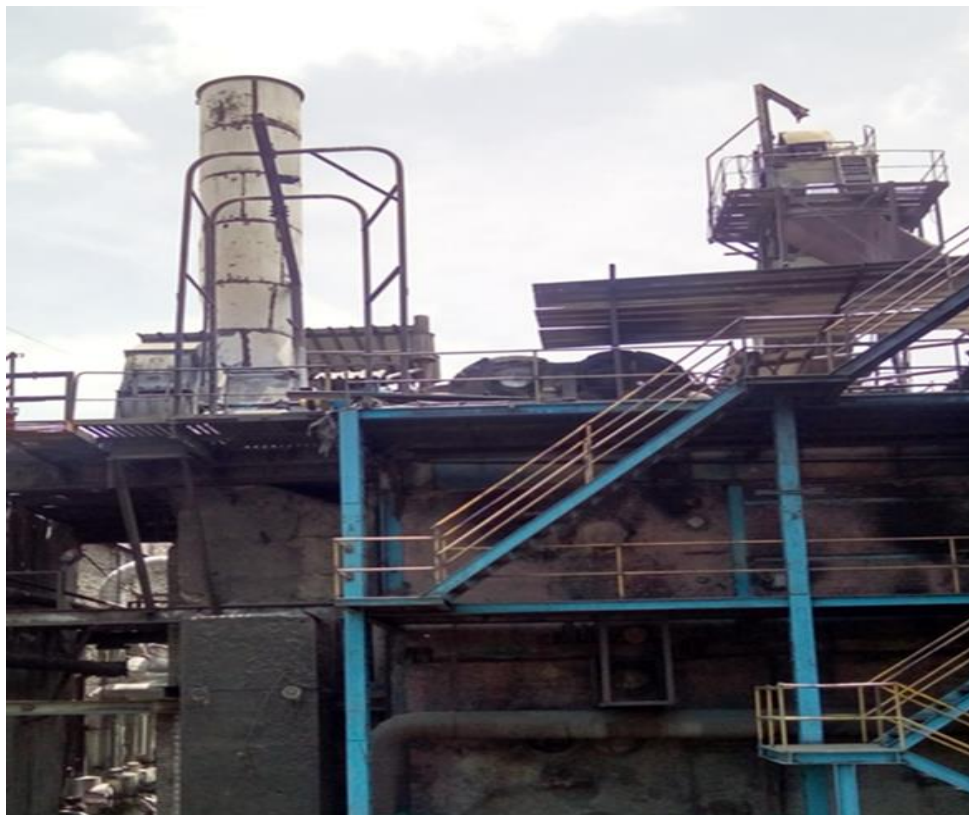
Caldera No 01 – Vista lateral
