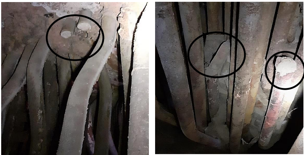
Figura 6. Tubería rota, banco convectivo frontal. Caldera No 01.
