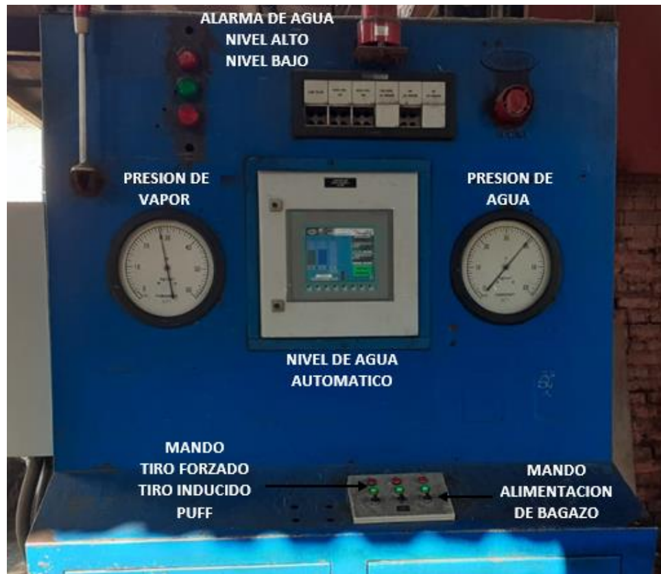
Figura 5. Panel de control de la Caldera No 01. Pomalca
