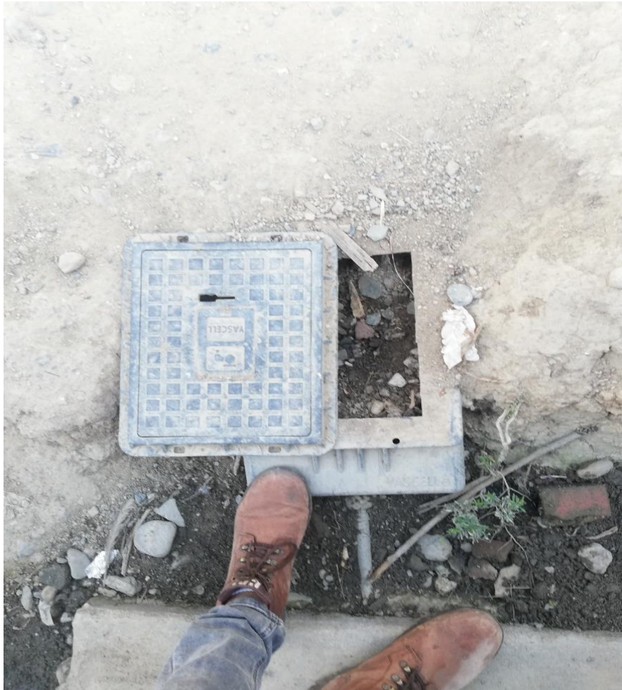
Foto 23. Caja de control de UBS
