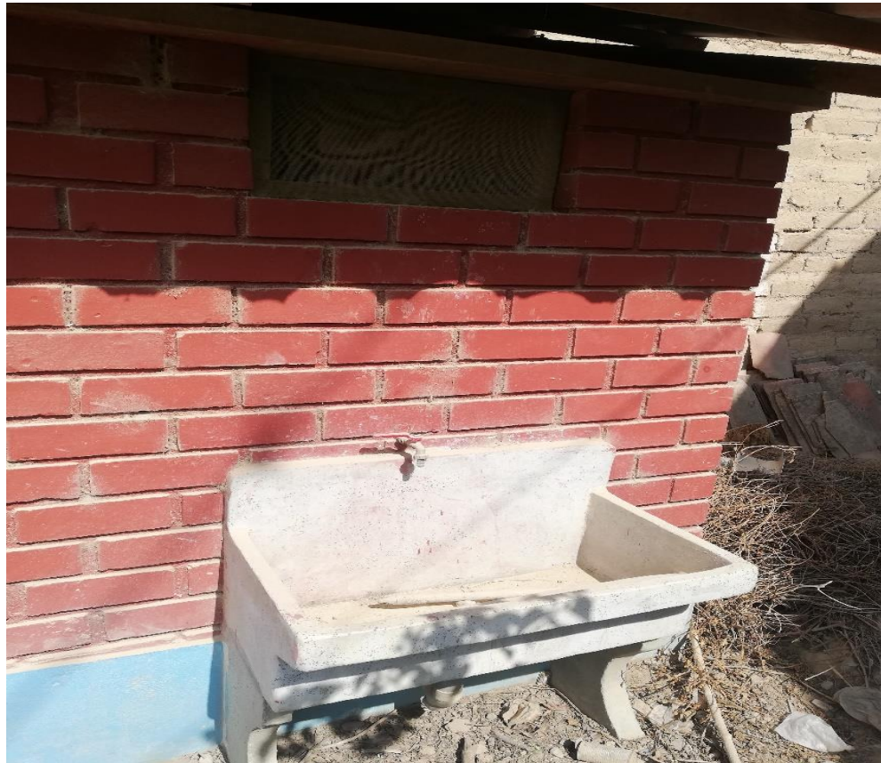
Foto 21 y 22. Unidad Básica de Saneamiento (UBS) en mal estado
