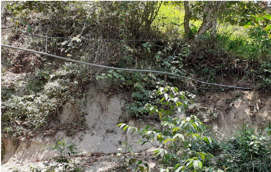
Foto 11. Mal Estado de los pases aéreos
