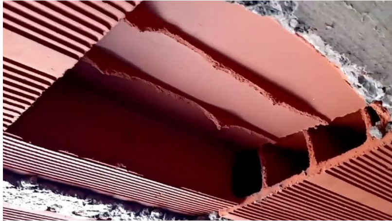
Figura 2. Ladrillo de techo fracturado
