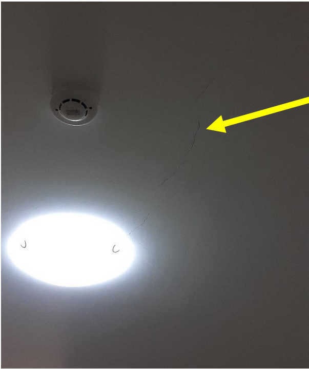
Imagen 11: Fisuras en las losas (techos) del hall de ingreso a los departamentos
