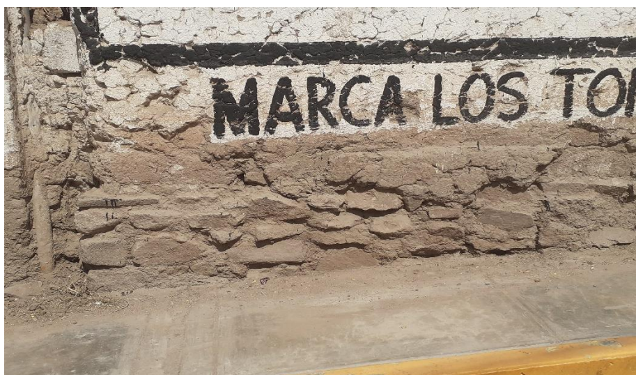
Cimientos expuestos vivienda 11
