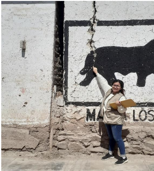
Grieta vertical de gran espesor
