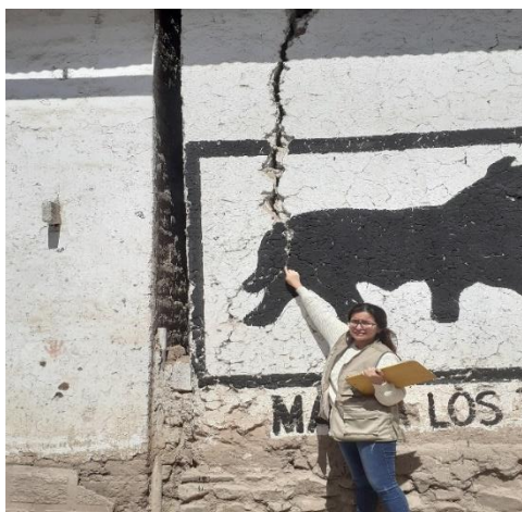
Figura 22 Grietas y fisuras en vivienda 11
