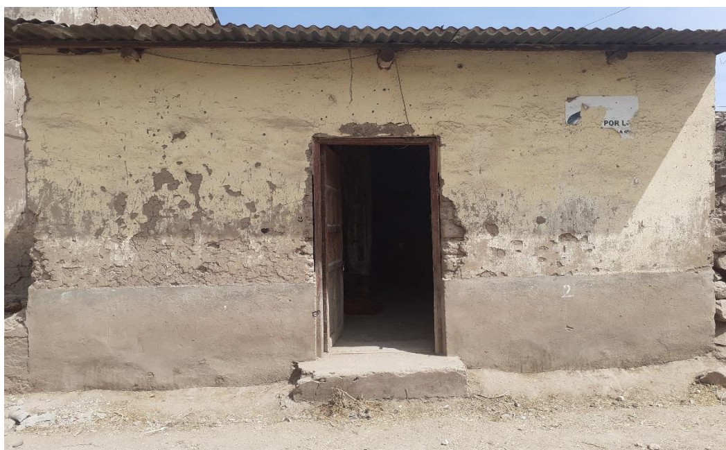
Ausencia de diafragma horizontal en vivienda 1
