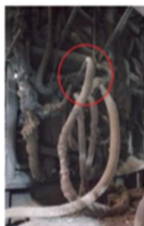
VISTA DE LA ZONA DEL ACCIDENTE
