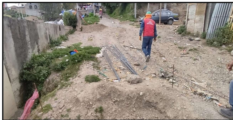
Figura 2. Deterioro de la superficie de la vía por efecto de las lluvias en el Jr. Las Perlas – El Tambo – Huancayo 2022
