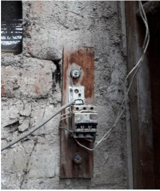
Falta de Señalética
