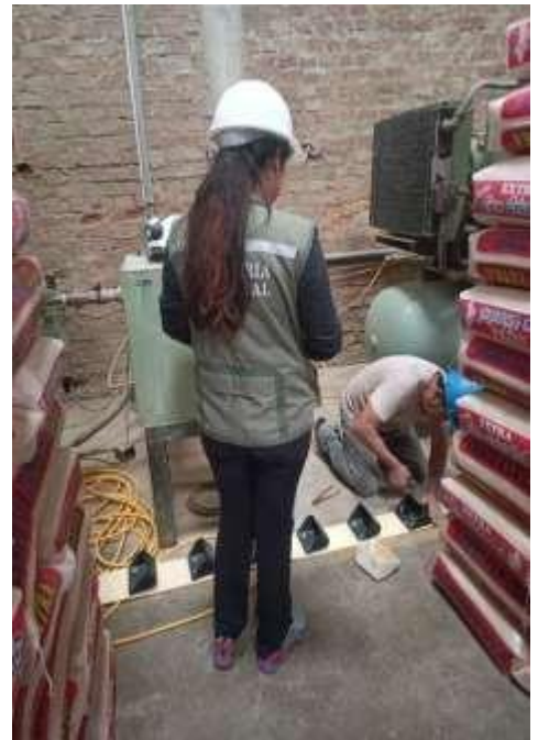
Figura 13 Mantenimiento de elevadores
