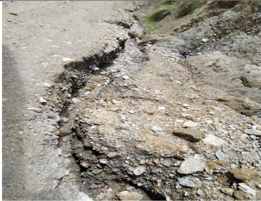
Foto 17. Grietas con profundidad significativa
