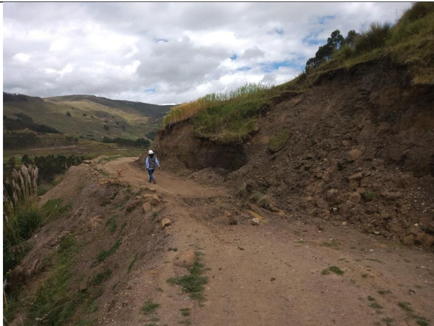
Foto 8. Falla en los taludes
