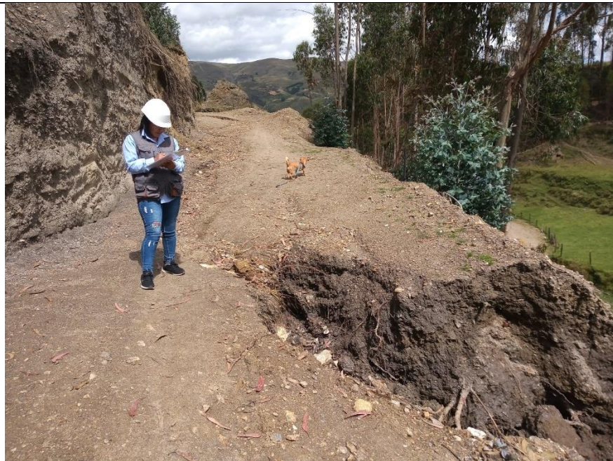
Foto 10. Deslizamiento de taludes
