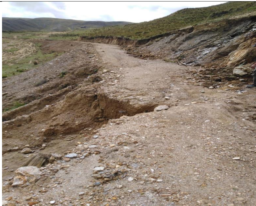
Foto 18. Erosión del talud
