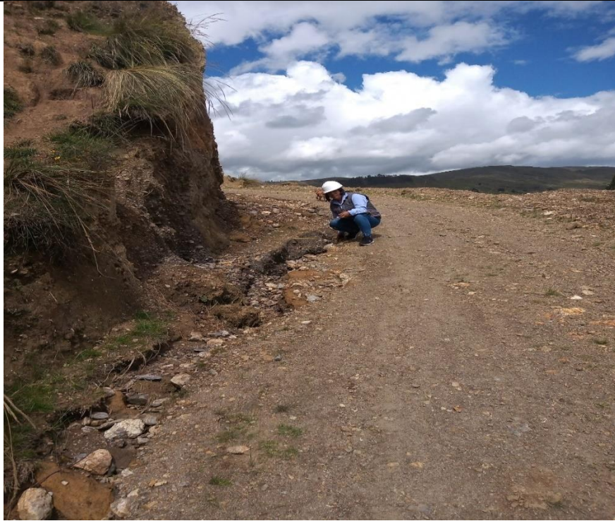
Foto 13. Medición de los huecos producto de erosión
