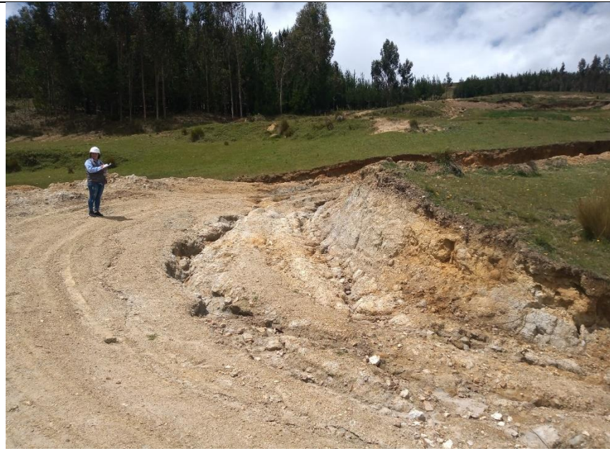
Foto 15. Secuelas de las escorrentías en el borde del camino
