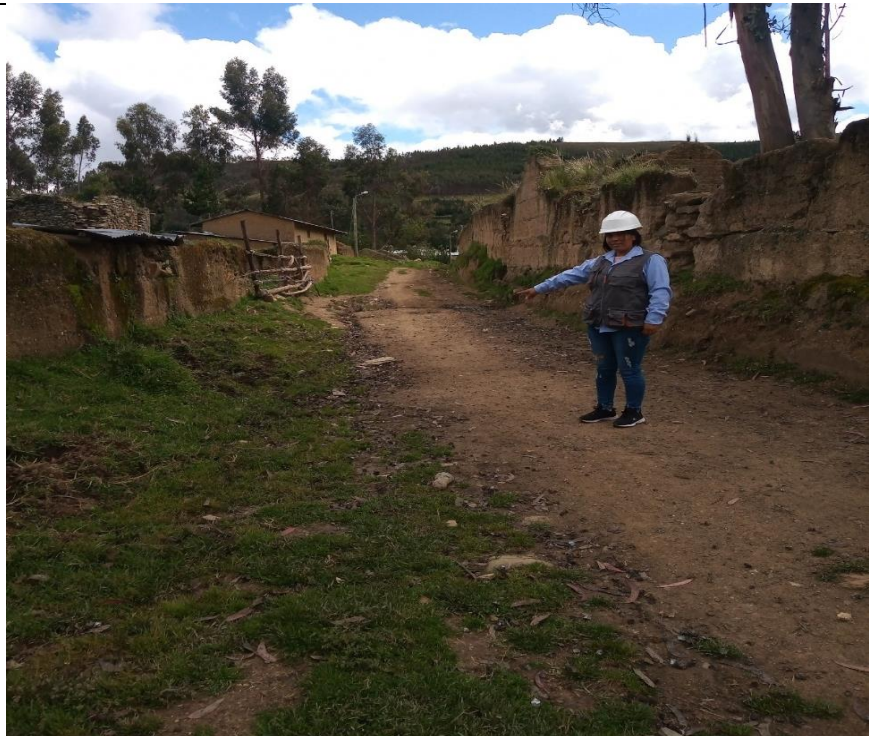
Foto 6. Inexistencia de cunetas
