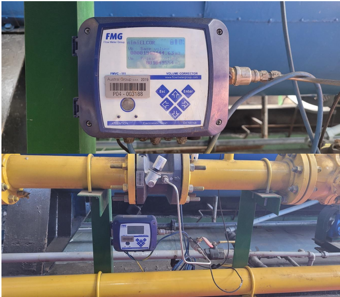
Flujómetro para el combustible (gas natural)
