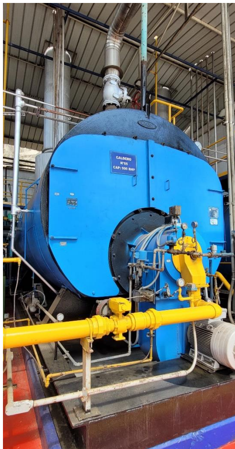
Figura 10. Caldera Piro-tubular de 900 BHP - Distral Fuente: Elaboración propia
