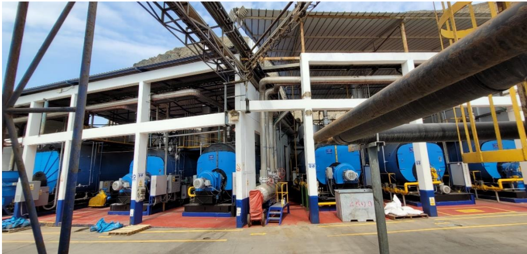
Figura 9. Sala de calderas Fuente: Elaboración propia
