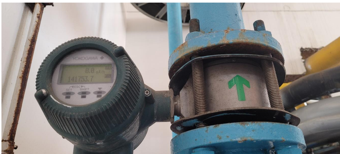
Flujómetro para el agua de alimentación (agua blanda)
