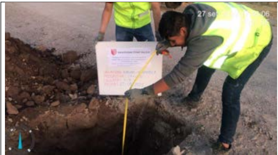
Imagen 4: Se observa la medida de la calicata N° 01 a 1.50 m de profundidad.
