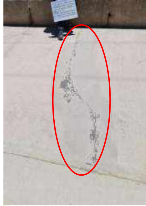
Figura 22: en la imagen se muestra una grieta transversal (GT), en la losa del pavimento rígido, en el Jr. Umachiri, de la localidad de ayaviri, de la provincia de melgar.
