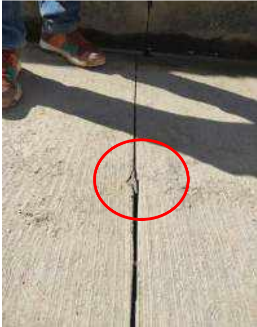
Figura 17: en la imagen se muestra una falla en la junta de contraccion, ya que se aprecia desportillamiento de sus bordes.
