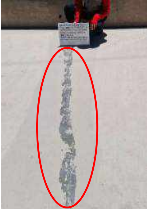
Figura 21: en la imagen se muestra una grieta transversal (GT), en la losa del pavimento rígido, en el Jr. Umachiri, de la localidad de ayaviri, de la provincia de melgar.
