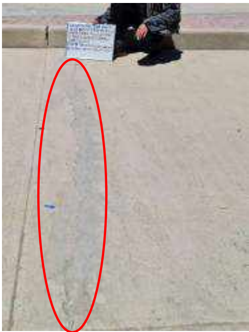
Figura 27: en la imagen se muestra una grieta transversal (GT), en la losa del pavimento rígido, en el Jr. Umachiri, de la localidad de ayaviri, de la provincia de melgar.
