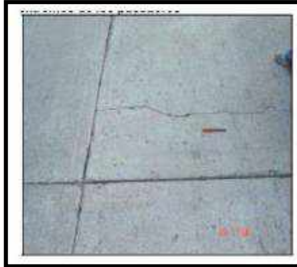
Figura 05. Grietas en los extremos de pasadores
