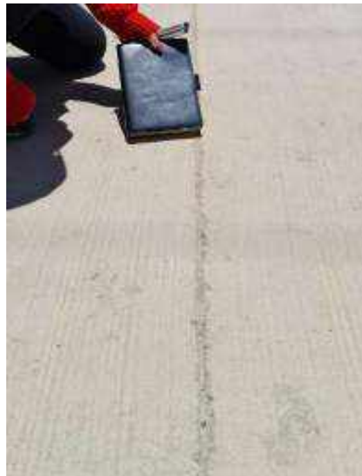
Figura 20: En la imagen se muestra en la imagen se aprecia el aserrado de una junta de contraccion, sin embargo esta presenta desportillamiento en sus bordes, ello se debe a un aserrado en tiempo inoportuno, el concreto ya estaba muy endurecido.
