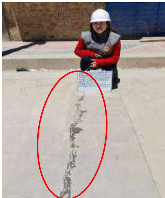
Figura 29: en la imagen se muestra una grieta transversal (GT), en la losa del pavimento rígido, en el Jr. Umachiri, de la localidad de ayaviri, de la provincia de melgar.
