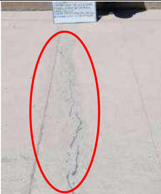
Figura 34: en la imagen se muestra una grieta transversal (GT), en la losa del pavimento rígido, en el Jr. Umachiri, de la localidad de ayaviri, de la provincia de melgar.
