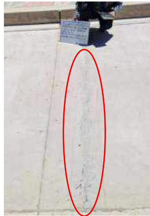
Figura 24: en la imagen se muestra una grieta transversal (GT), en la losa del pavimento rígido, en el Jr. Umachiri, de la localidad de ayaviri, de la provincia de melgar.
