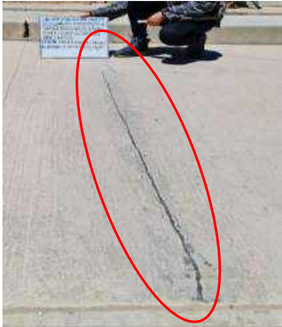
Figura 32: en la imagen se muestra una grieta transversal (GT), en la losa del pavimento rígido, en el Jr. Umachiri, de la localidad de ayaviri, de la provincia de melgar.
