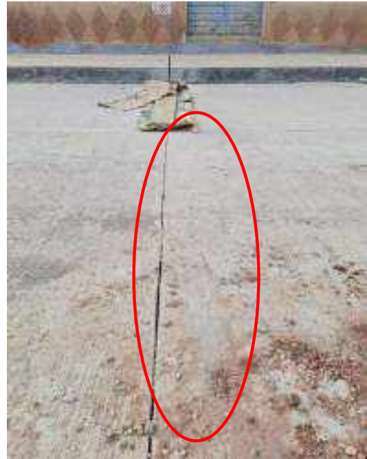
Figura 18: en la imagen se aprecia el aserrado de una junta de contraccion, sin embargo esta a su lado izquierdo presenta una grieta transversal (GT), esto se debe al aserrado en el momento inoportuno
