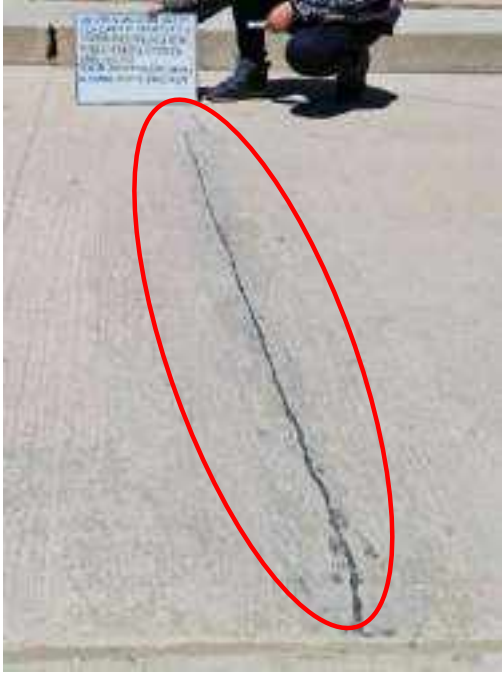
Figura 25: en la imagen se muestra una grieta transversal (GT), en la losa del pavimento rígido, en el Jr. Umachiri, de la localidad de ayaviri, de la provincia de melgar.
