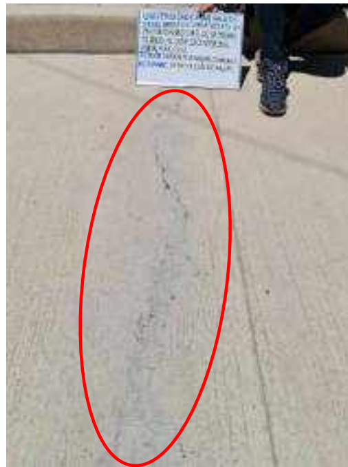
Figura 28: en la imagen se muestra una grieta transversal (GT), en la losa del pavimento rígido, en el Jr. Umachiri, de la localidad de ayaviri, de la provincia de melgar.
