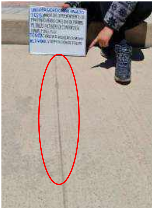
Figura 23: en la imagen se muestra una grieta transversal (GT), en la losa del pavimento rígido, en el Jr. Umachiri, de la localidad de ayaviri, de la provincia de melgar.
