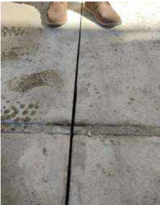
Figura 19: en la imagen la junta de contraccion, la cual presenta discontinuidad en su tramo, esto debido a que el operador no realizo el corte de manera recta.
