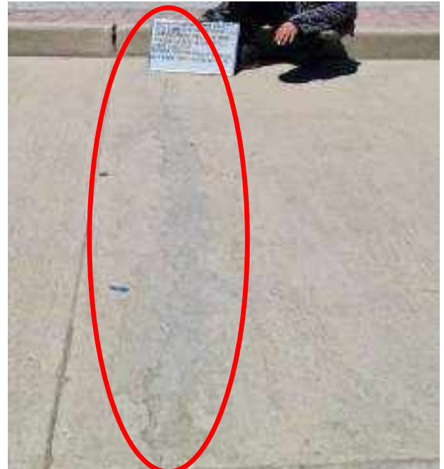
Figura 33: en la imagen se muestra una grieta transversal (GT), en la losa del pavimento rígido, en el Jr. Umachiri, de la localidad de ayaviri, de la provincia de melgar.
