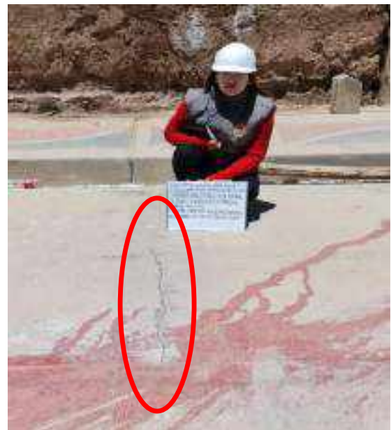
Figura 35 en la imagen se muestra una grieta transversal (GT), en la losa del pavimento rígido, en el Jr. Umachiri, de la localidad de ayaviri, de la provincia de melgar.
