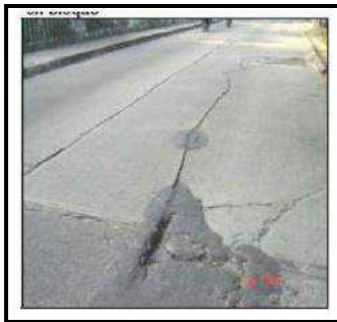
Figura 06. Grieta en bloque
