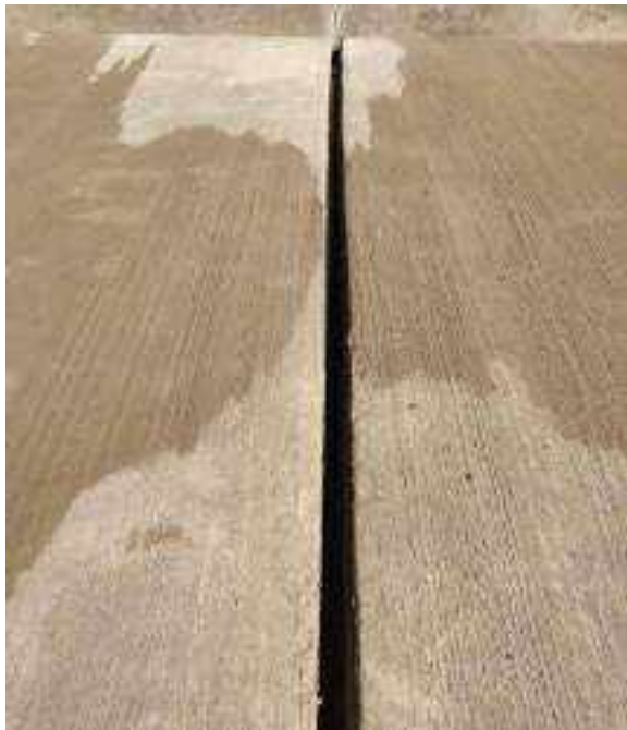
Figura 14: en la imagen se aprecia la junta de contraccion transversal la cual es el resultado de la insercion de platinas metalicas, esta tiene una abertura de 6mm.
