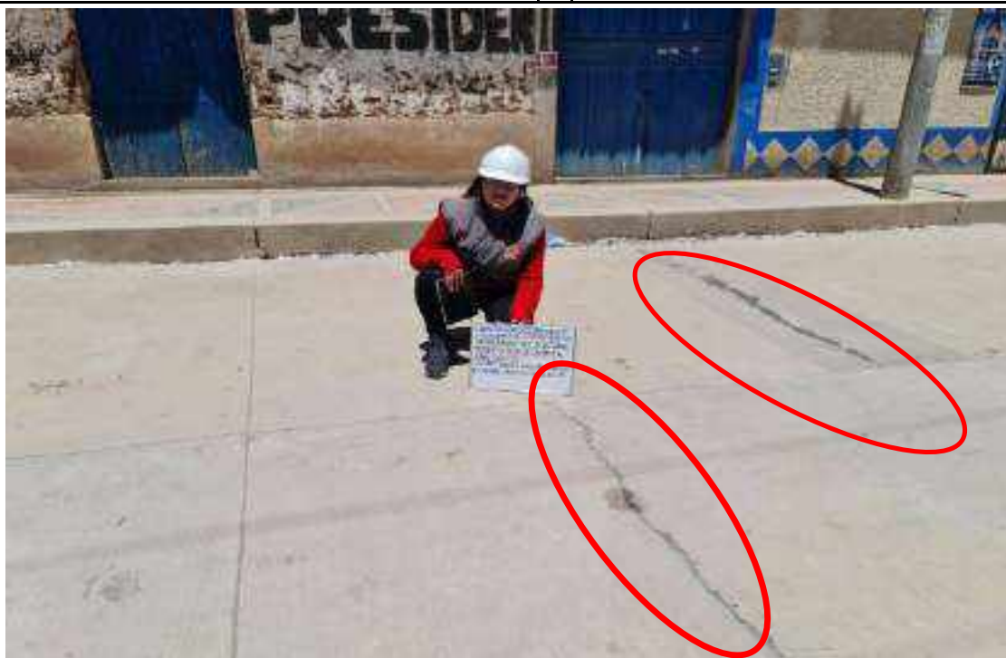
Figura 31: en la imagen se muestra 02 grietas transversales (GT), en la losa del pavimento rígido, en el Jr. Umachiri, de la localidad de ayaviri, de la provincia de melgar.
