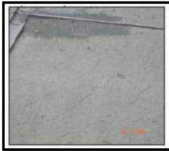
Figura 07. Grietas de aparición temprana
