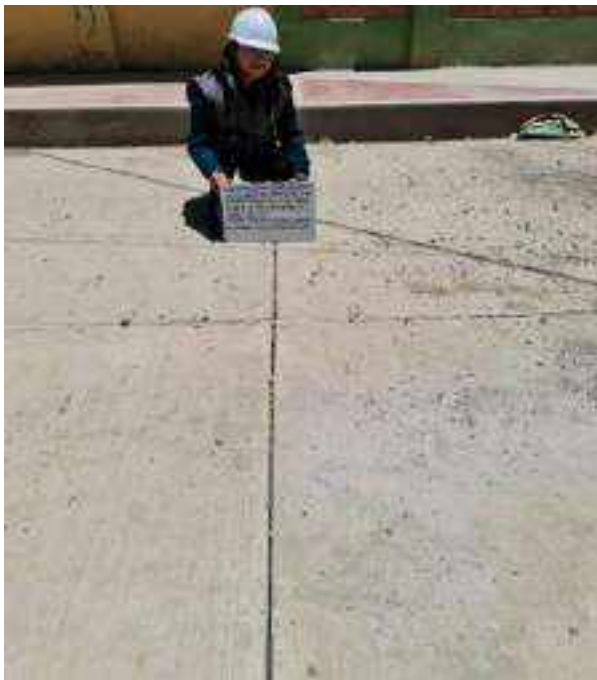
Figura 09: en la imagen se aprecia la junta de contraccion transversal la cual es el resultado de la insercion de platinas metalicas, esta tiene una abertura de 6mm.
