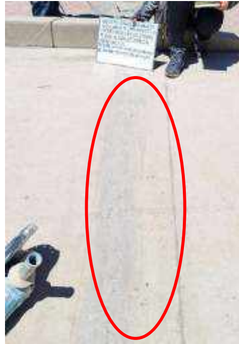
Figura 26: en la imagen se muestra una grieta transversal (GT), en la losa del pavimento rígido, en el Jr. Umachiri, de la localidad de ayaviri, de la provincia de melgar.
