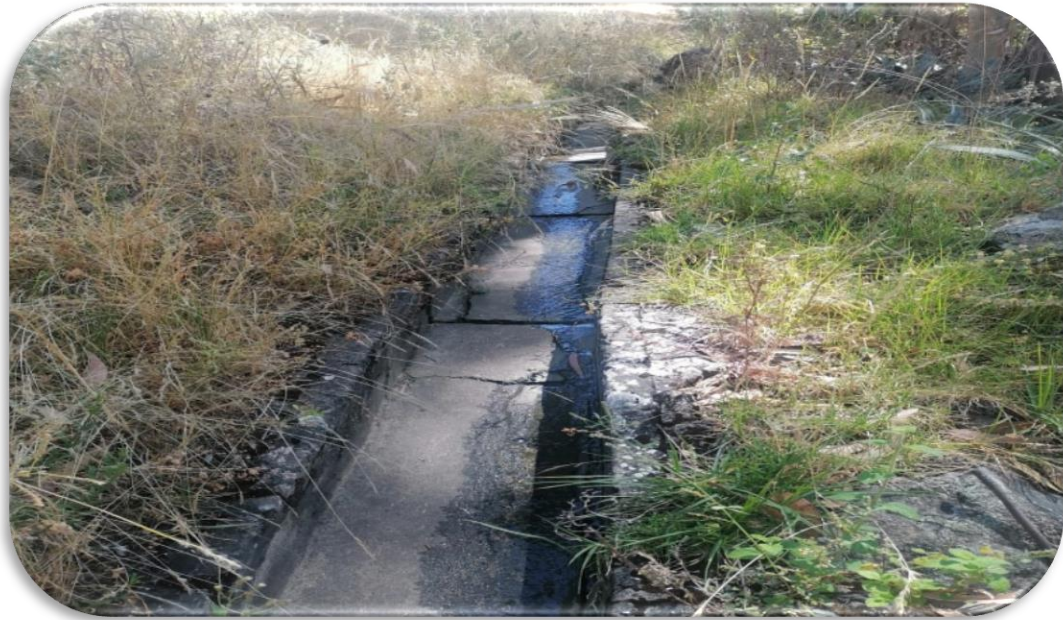
Foto N.9: Canal de irrigación con lesiones y fallas
