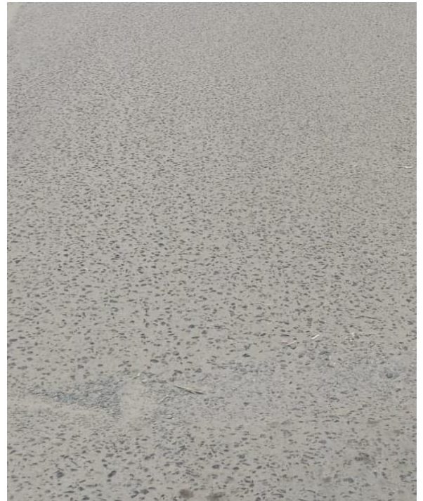
Progresiva 0+800 Falla: Desprendimiento de Agregados
