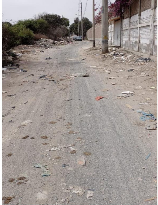
Progresiva 0+2100 Falla: Desprendimiento de agregado
