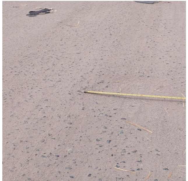
Progresiva 0+2500 Falla: Huecos
