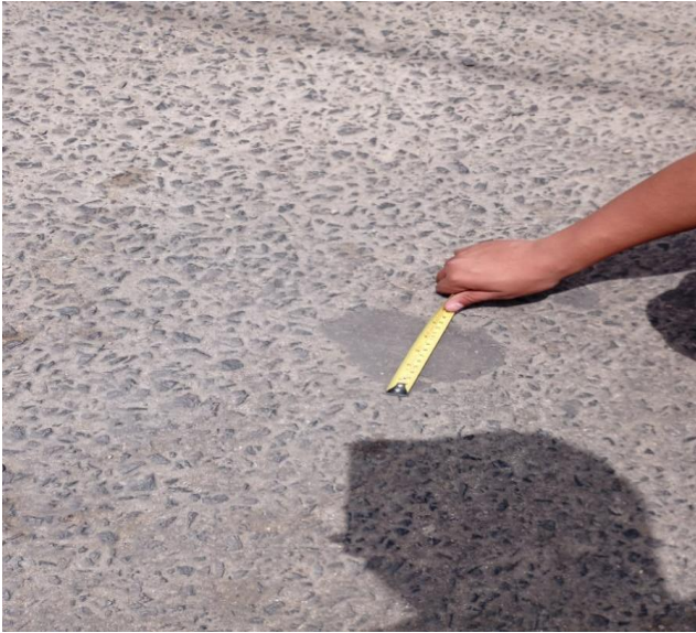
Progresiva 0+700 Falla: Parcheo
