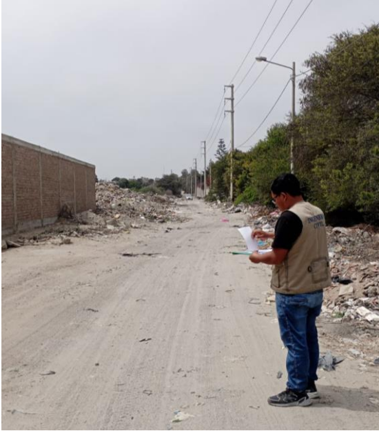
Progresiva 0+2000 Falla: Desprendimiento de agregados
