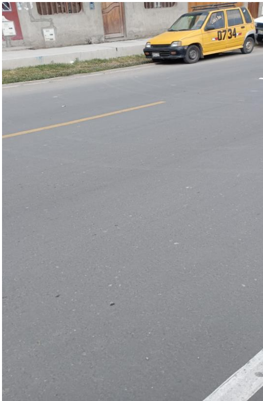
Progresiva 0+1500 Falla: Parcheo
