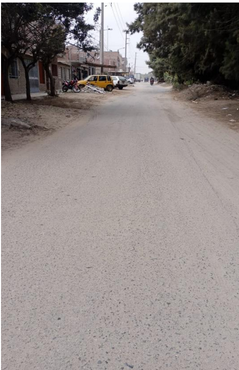
Progresiva 0+2350 Falla: Grieta de borde
