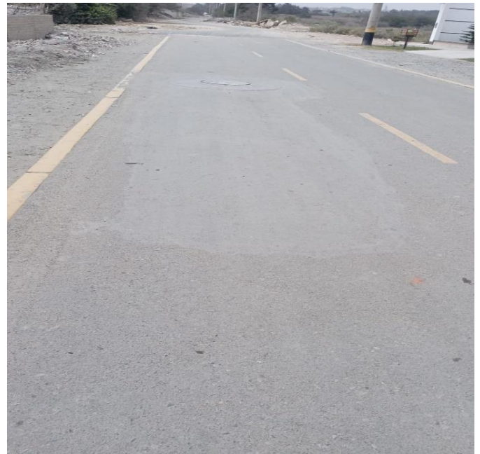
Progresiva 0+1750 Falla: Parcheo
