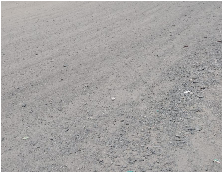
Progresiva 0+450 Falla: Desprendimiento de Agregados
