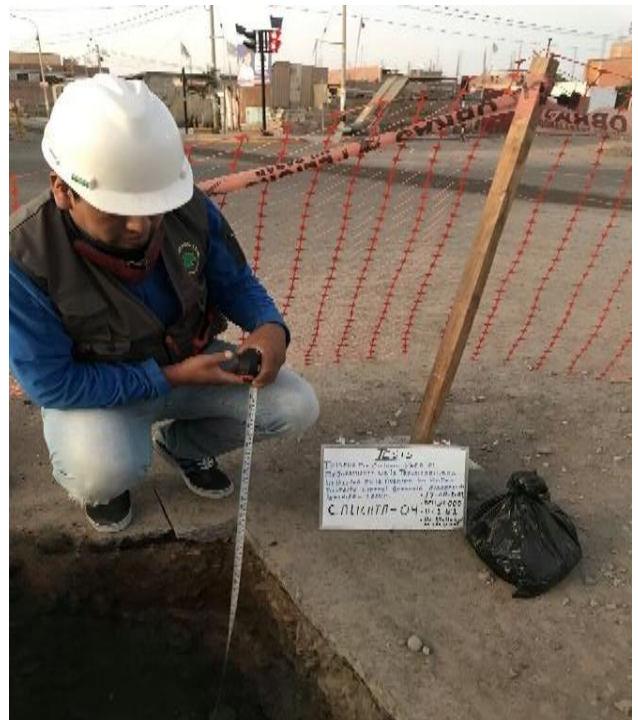
Foto 32: Medición de la profundidad de la calicata 04 h=1.5 metros ubicada en el tramo final.
