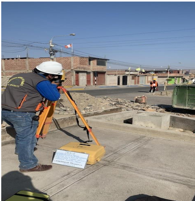
Foto 7: Se observa el trabajo topográfico con bastón y prisma como parte del levantamiento topográfico
