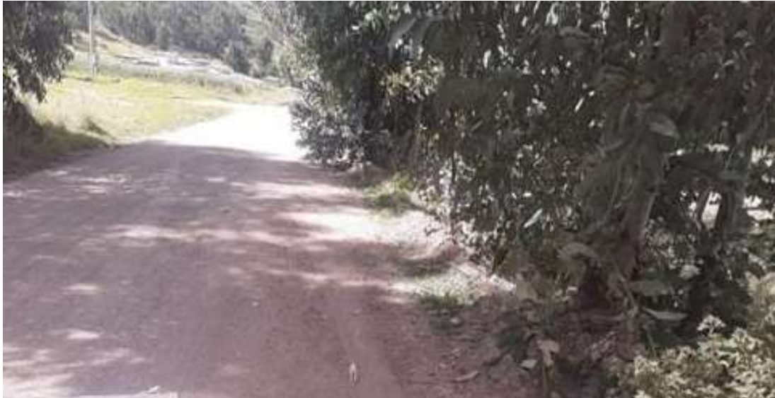
Figura 4. Estado situacional de la vía afirmada
