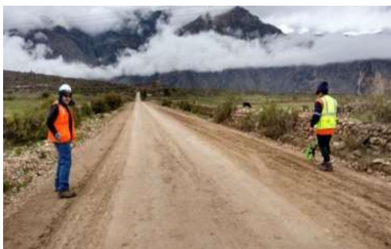
Figura 3. Relevamiento de defectos en vías no pavimentadas
