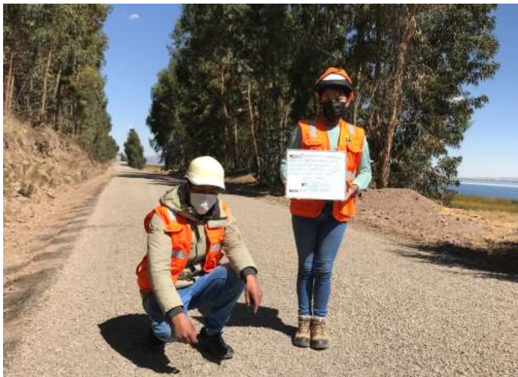
Figura 14. Superficie a nivel de afirmado Km 29+700
