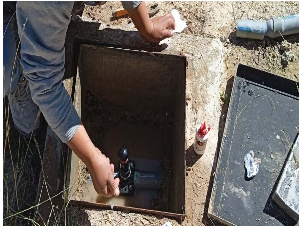
Figura 17. Filtración de agua en la válvula de aire por mala conexión y falta de mantenimiento Fuente: Elaboración Propia
