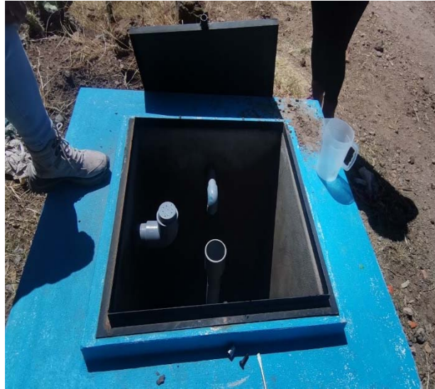
Figura 14. Llegada de Agua entre cortada por falta de válvula de aire. Fuente: Elaboración Propia
