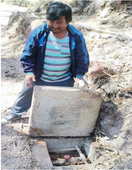
Figura 13. Obstrucción en la cámara de purga. Fuente: Elaboración Propia
