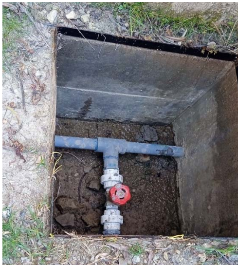
Figura 15. Filtración en la válvula de purga. Fuente: Elaboración Propia
