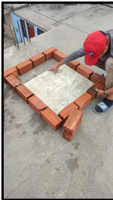
Figura 15. Alineación de ladrillos para la construcción de prototipo con 25% de eps reciclado
