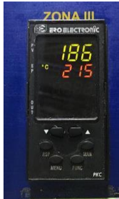
Figura 62. Modulador que controla temperaturas del horno con falla.
