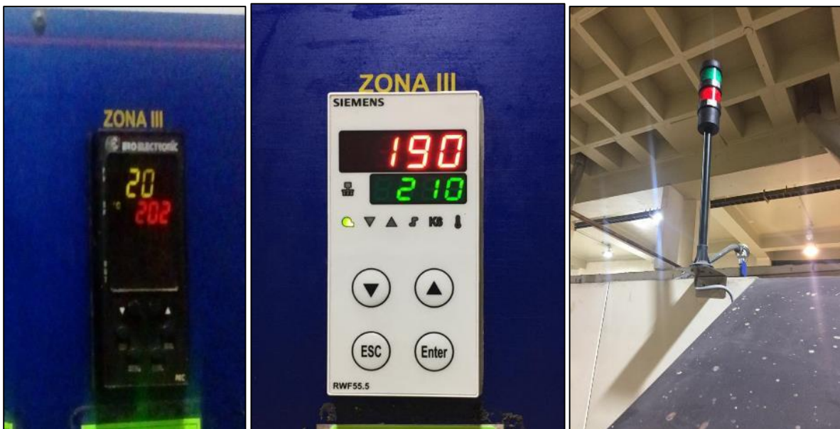
Figura 75. Modulador que controla temperatura de horneado con falla antes, Cambio de modulador y baliza nuevo después
