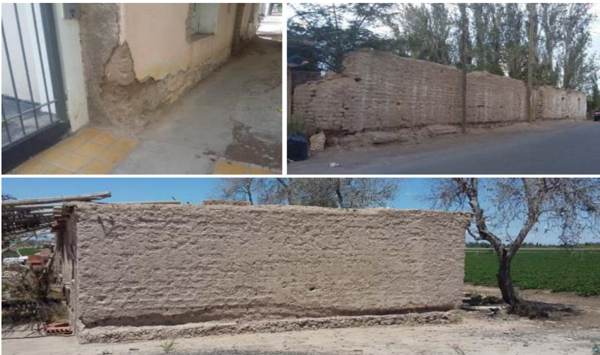
Figura 1. Deterioro de muros de adobe con pérdida significativa de sección transversal. Obtenido de (Garino et al. , 2016, p. 03).
