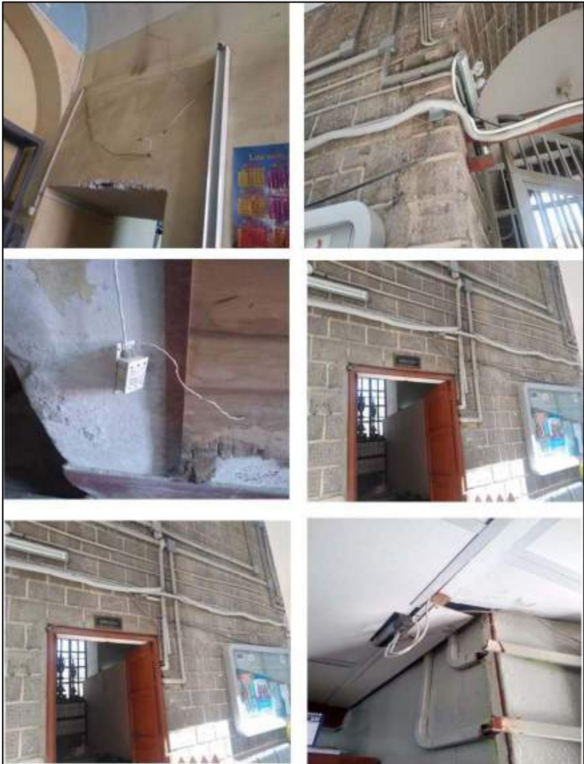
Figura 18. Vista interior de las instalaciones eléctricas de la infraestructura actual de la DREA.
