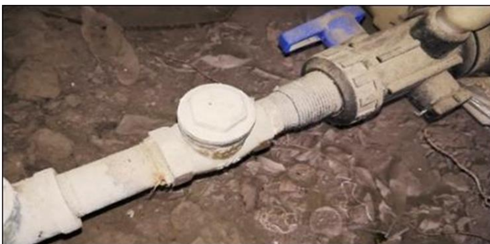
Figura 6. Check de retorno deteriorado (Antes)
