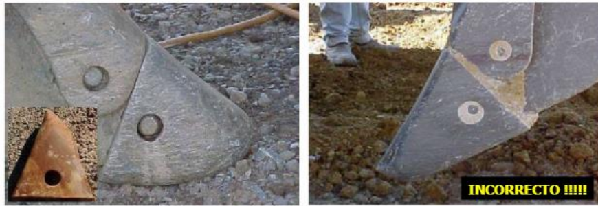
Figura 3. Inadecuado ángulo de penetración
