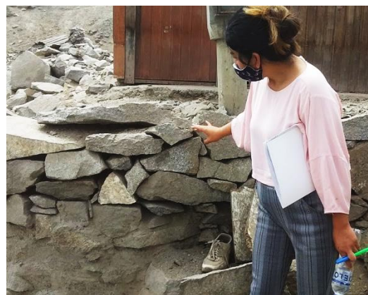
Figura 34. Unión de rocas que se desprenden
