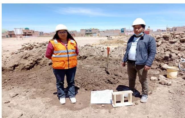
IMAGEN 15: Mezclado de fibras de cabuya con la tierra de cantera designada según laboratorio.
